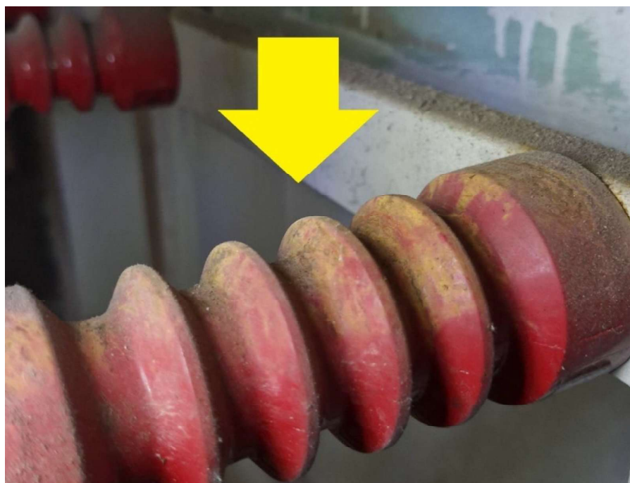
Foto 7: Descargas parciais severas nos isoladores de Epóxi.
