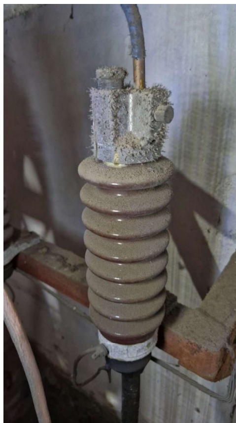
Foto 2: Excesso de contaminantes nos terminais elétricos dos cabos de potência, cerâmicos.
