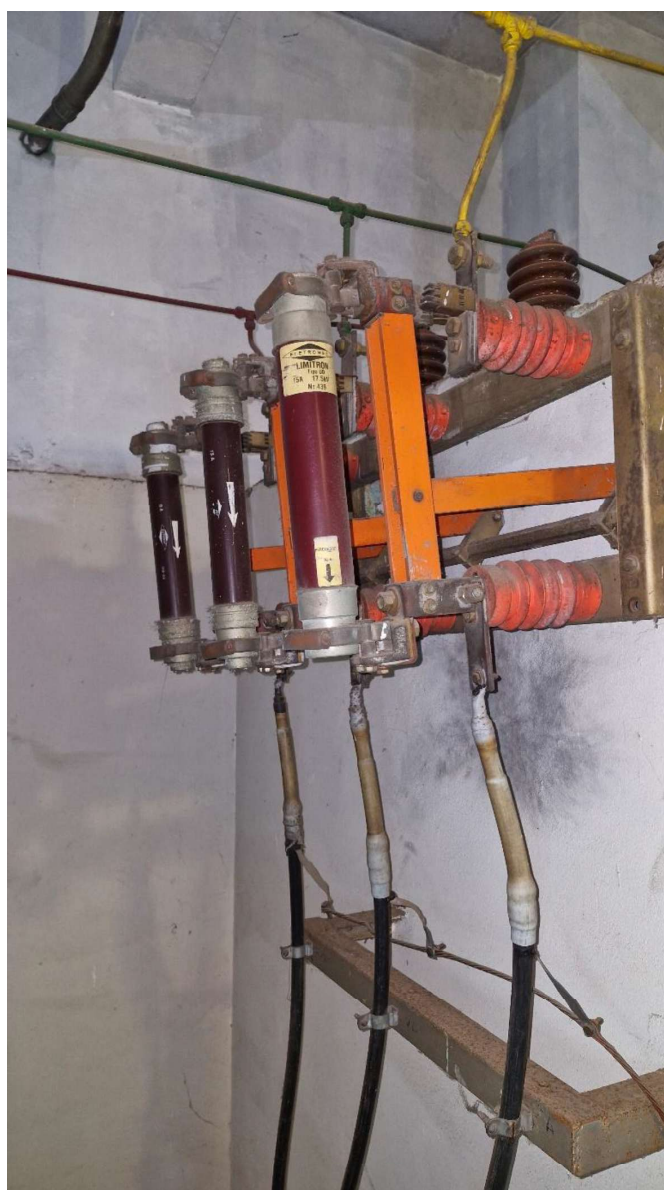
Foto 10: Chave seccionadora tripolar, com fusíveis, Subestação Auxiliar 2.
