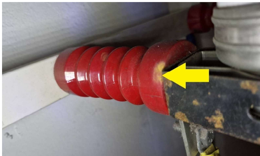
Foto 8: Descargas parciais severas nos isoladores de Epóxi.
