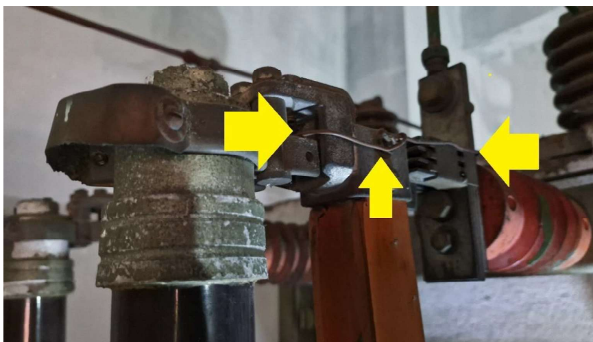
Foto 11: Chave seccionadora amarrada com arame, impossibilitando sua abertura e fechamento.
