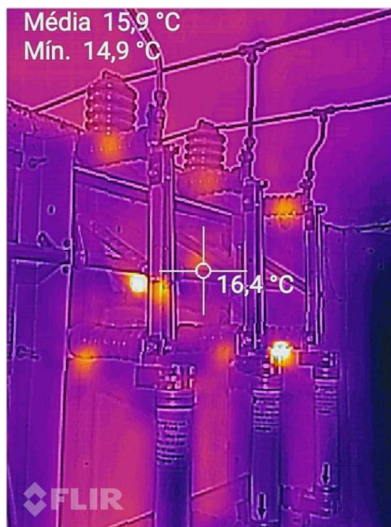
Foto 9: Imagem térmica da chave seccionadora de MT, com alterações.
