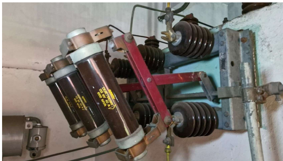
Foto 13: Chave seccionadora tripolar, com fusíveis, Subestação Principal, sem alterações.
