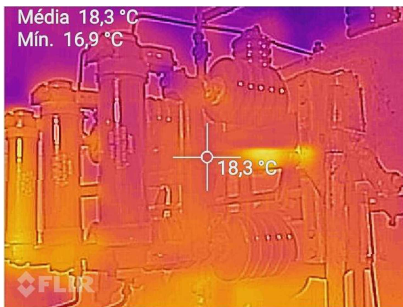
Foto 14: Imagem térmica da chave seccionadora de MT, com alterações.
