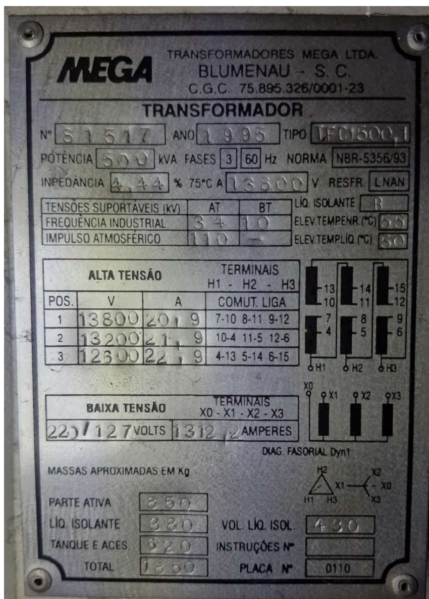
Foto 16: Detalhe da placa de identificação do transformador.
