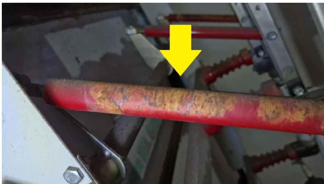
Foto 6: Descargas parciais severas no mecanismo de acionamento da chave.
