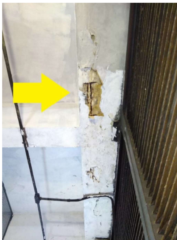
Foto 1: Deslocamento de viga e ferragens expostas.
