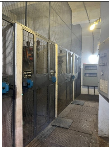
Imagem 4: Área interna da subestação.
