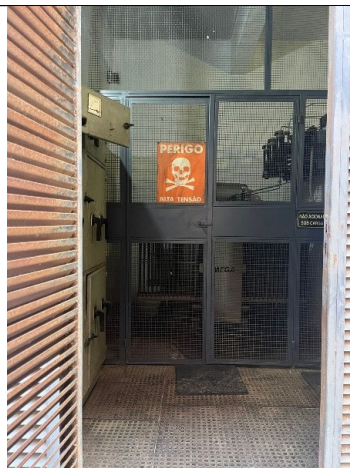
Imagem 2: Entrada interna da subestação.
