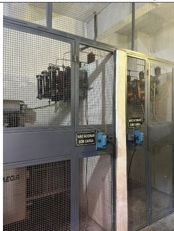
Imagem 3: Área interna da subestação.
