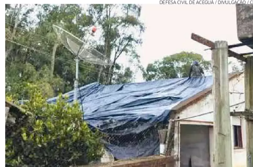
Em Aceguá, casas foram destelhadas pela força do vento
