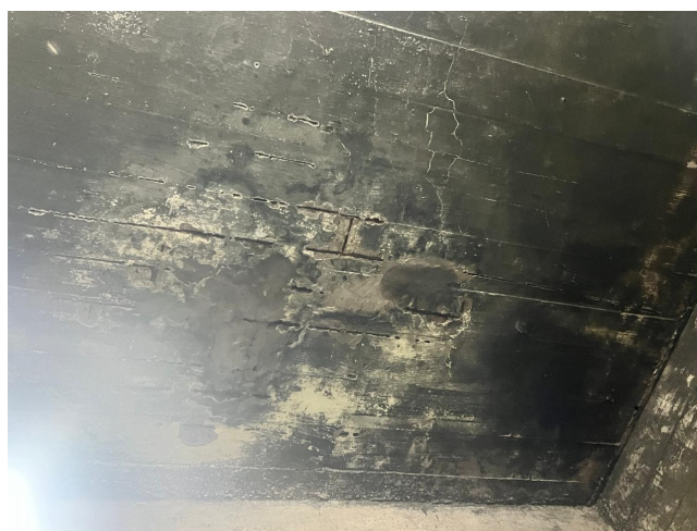
Laje do depósito de pneus
