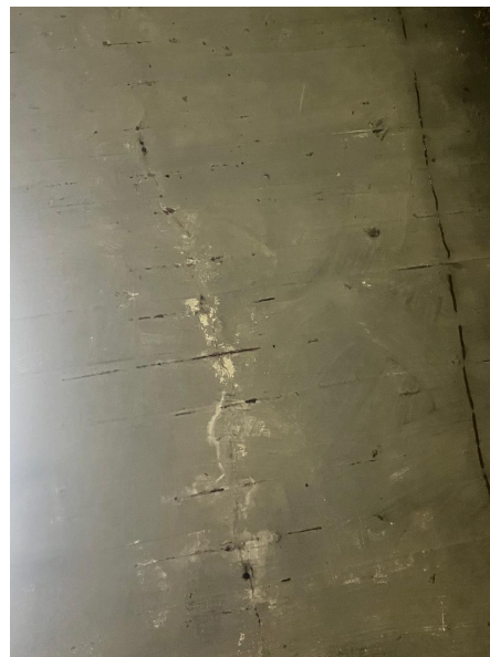
Laje do depósito de pneus
