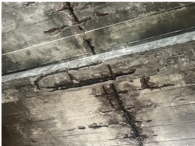
Laje do depósito de pneus
