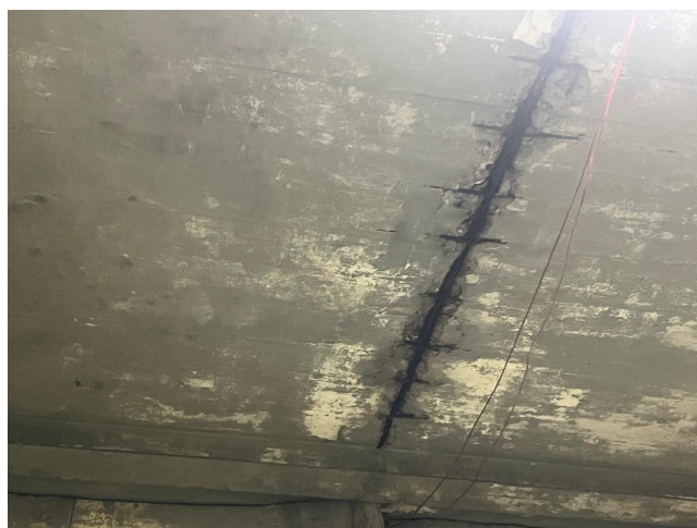
Laje do depósito de pneus
