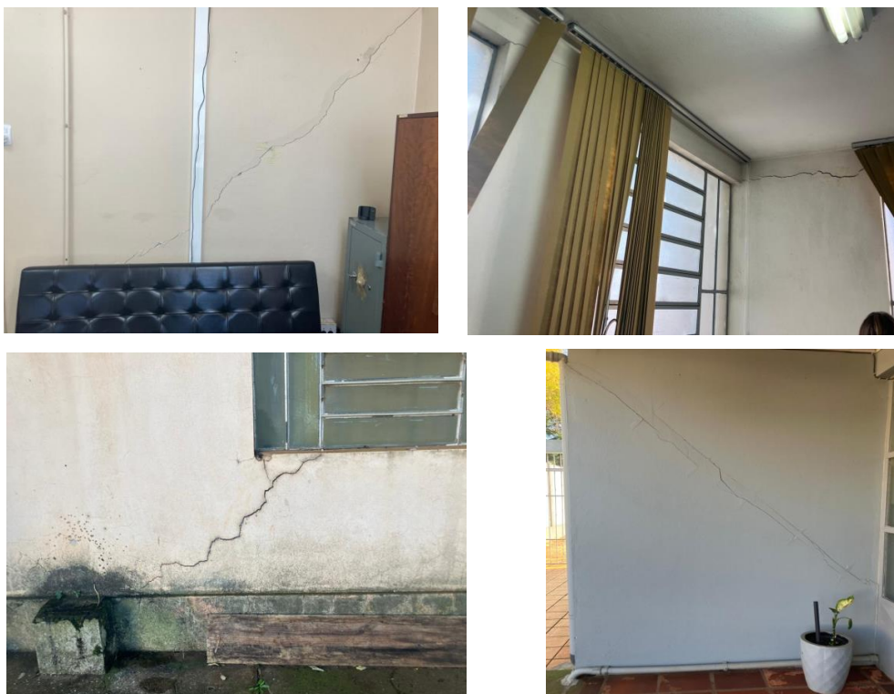
Fissuras/Trincas a serem reparadas
