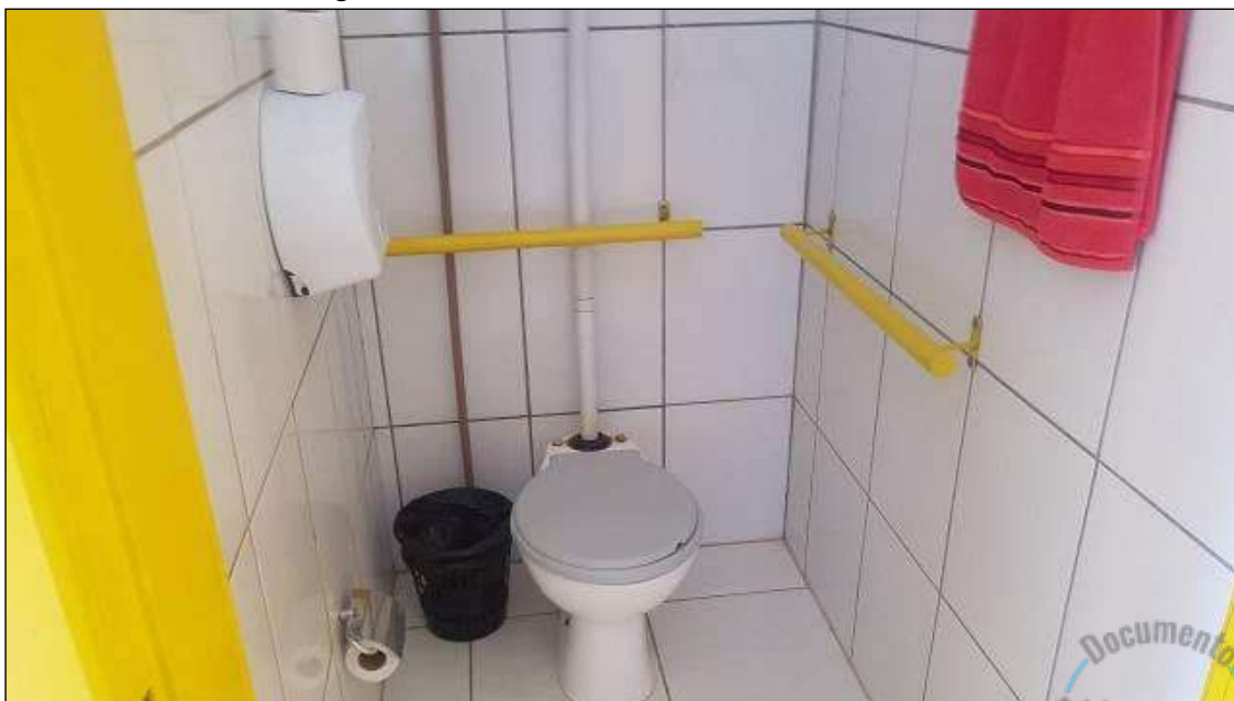
Figura 118 – Sanitário Feminino / Bacia sanitária
