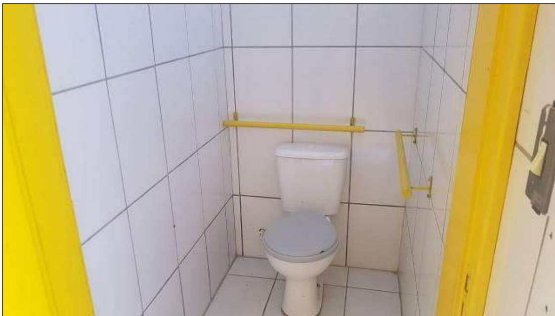
Figura 117 – Bacia sanitária / Sanitário Masculino
