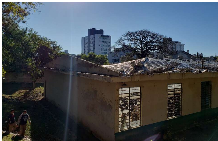
Figura 02: Vista de cima da cobertura danificada.
