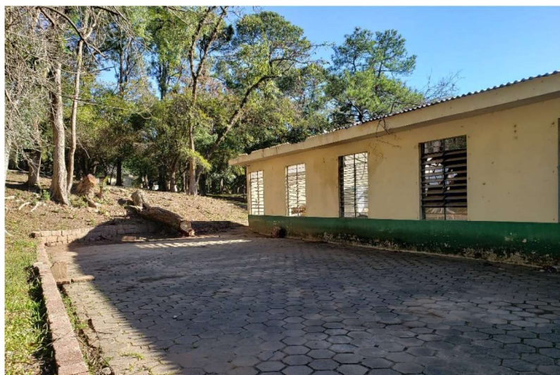
Figura 07: Vista externa do prédio – parte afetada.
