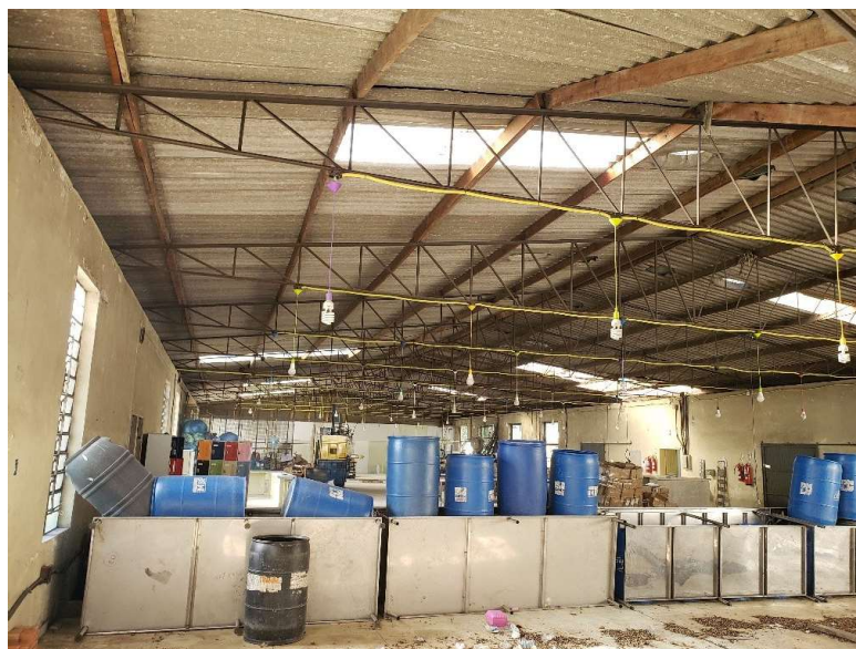
Figura 06: Vista do isolamento com mesas de aço, ao fundo encontra-se a parte não atingida do prédio.
