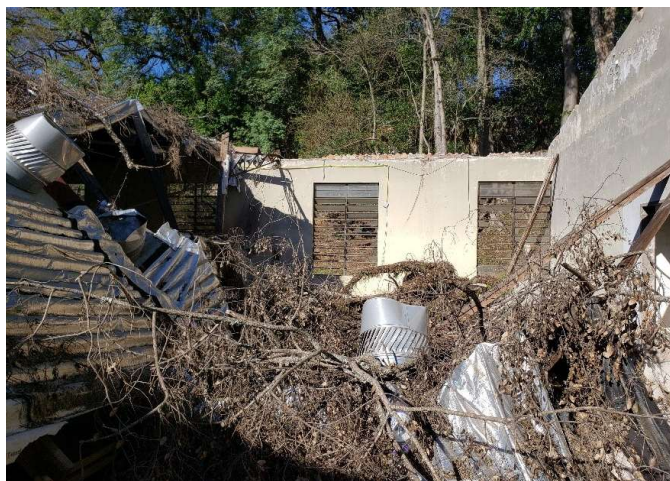
Figura 03: Escombros provenientes da cobertura danificada e restos de galhos da árvore caída.
