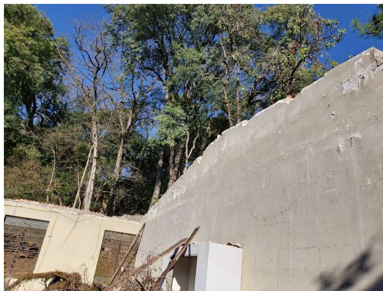
Figura 08: Vista da parte afetada, sem cobertura.
