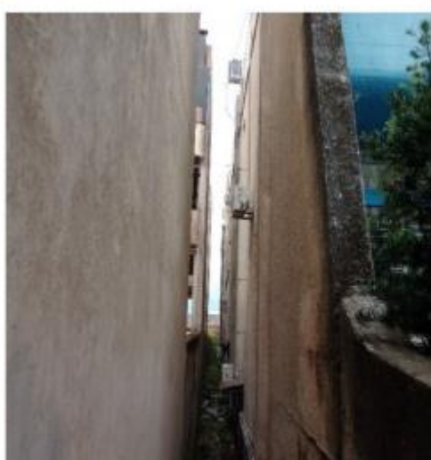
Local para instalação de condensadoras: Corredor lateral esquerdo.
