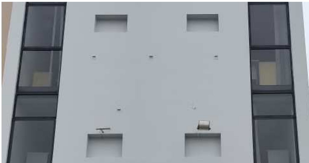
Figura 09. Fachada do edifício atual, com suportes e refletores que devem ser removidos.
