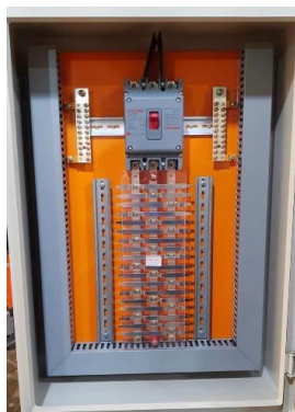
Figura 9: Exemplo de barramento com tampa de proteção acrílica.
