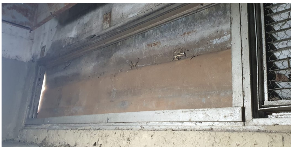
Imagem 02: Vedação provisória com chapa (local que foi colocada a chapa após furto das janelas)
