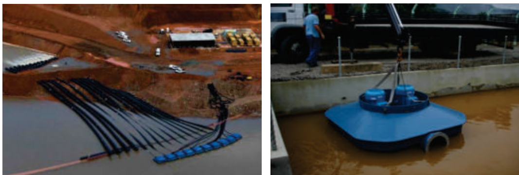
Figura 4.6. Sistema de bombeamento flutuante para captação de água
