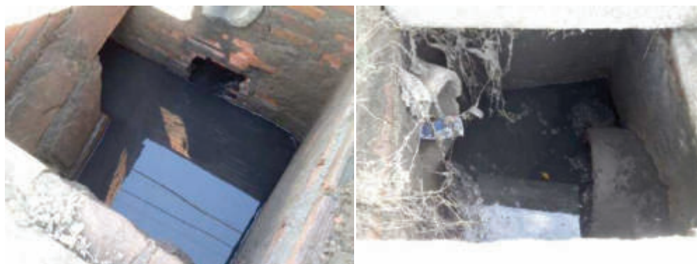
Figura 3.15: Escoamento insuficiente, por declividade inadequada
