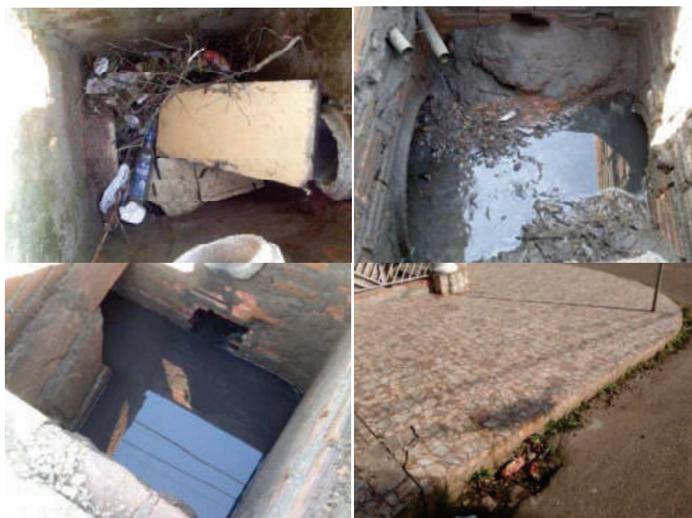
Figura 3.16: Má conservação da rede e das bocas de lobo
