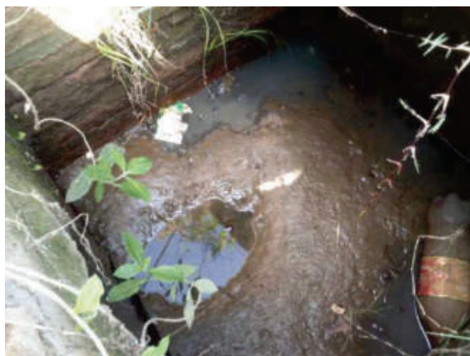
Tubulação totalmente assoreada
