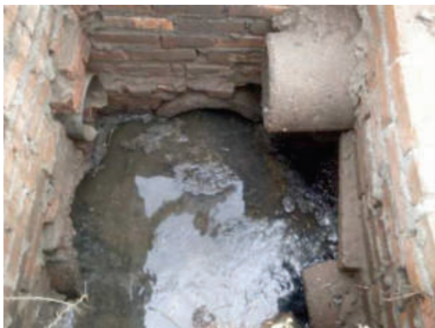
Caixa de inspeção com 5 tubulações
