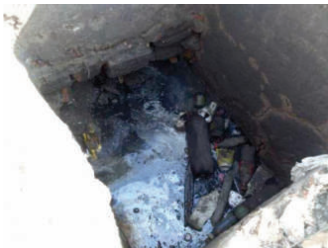
Lixo e tubulação assoreada
