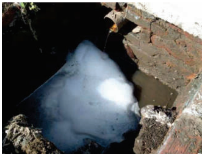
Ligação de esgoto doméstico na rede pluvial
