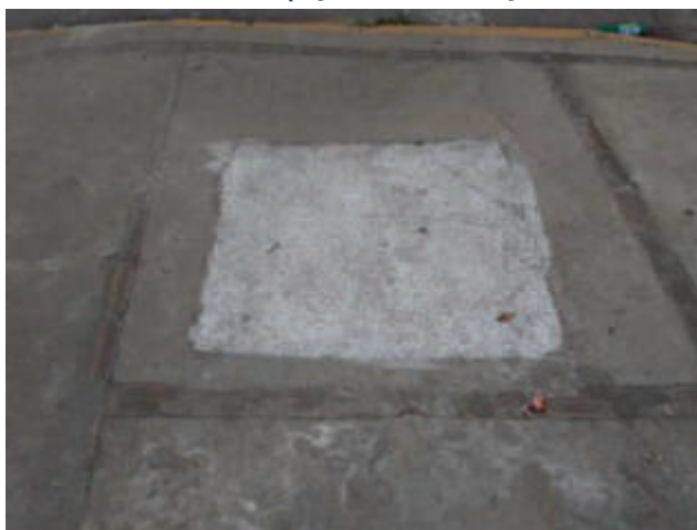
Caixa de inspeção lacrada
