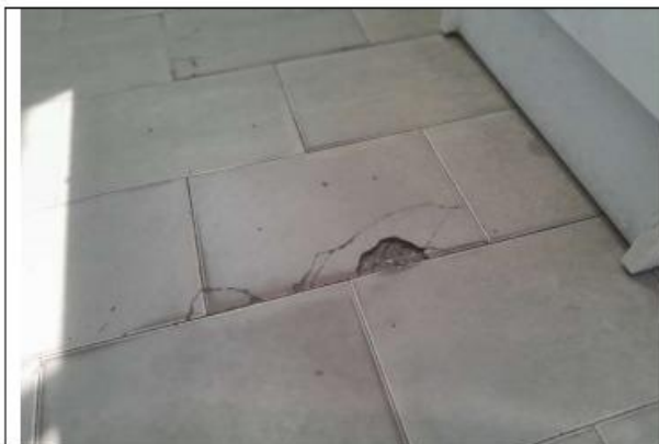
Placas de cerâmicas quebradas
