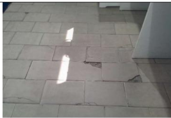
Piso cerâmico solto e com som cavo indicando problemas no contrapiso
