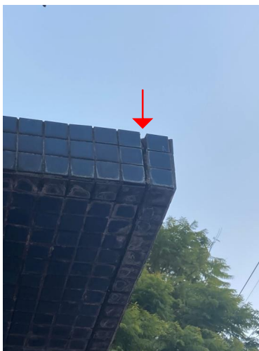
Figura 3: Constata-se o desprendimento parcial das pastilhas e do emboço – por consequência de falhas de aderência ao substrato.
