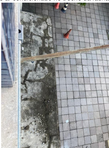
Figura 4: Fissuração da proteção mecânica e a presença de caliças em função da instalação de aparelhos de ar condicionado no trecho da fachada frontal do imóvel.
