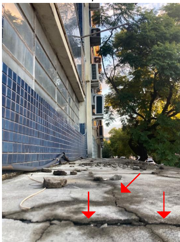
Figura 5: Desintegração da proteção mecânica, deixando a manta asfáltica exposta às intempéries e aos raios UV, favorecendo ações deletérias e, desse modo, reduz a vida útil da camada impermeável.
