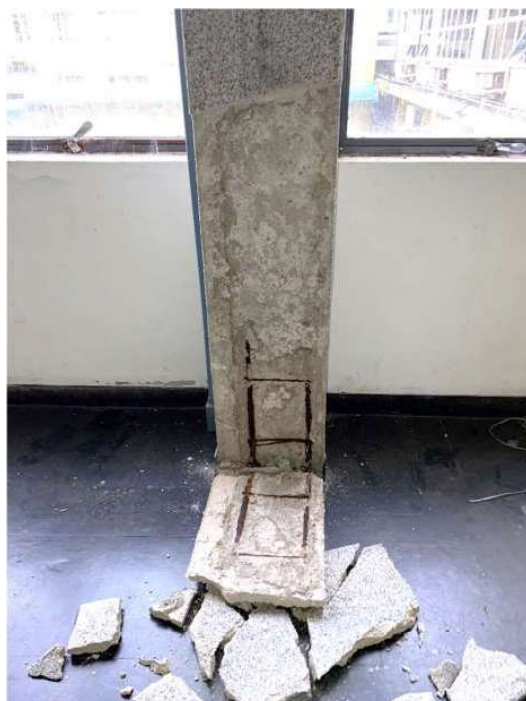
Figura 5: Revestimento de pilar removido para inspeção e constatação de corrosão de armadura.
