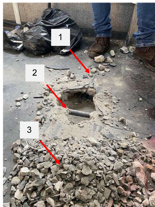
Figura 16: Fissura presente na regularização (1). Eletroduto embutido na regularização (2). Brita solta como elemento constituinte da regularização (3).
