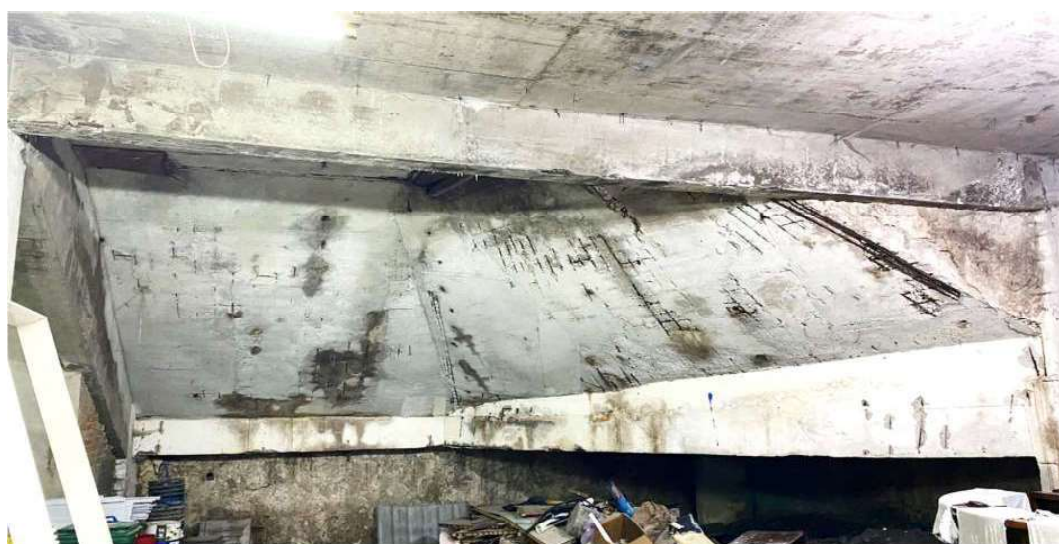
Figura 9: Armadura exposta em viga e laje da escadaria principal, acesso pela rua dos Andradas.
