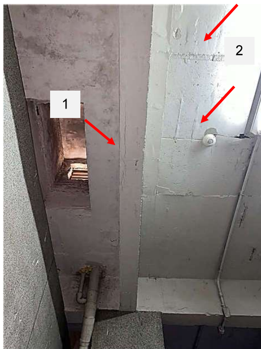
Figura 7: Fissura na face inferior de viga (1) e deslocamento em laje (2), proveniente da corrosão de armadura.
