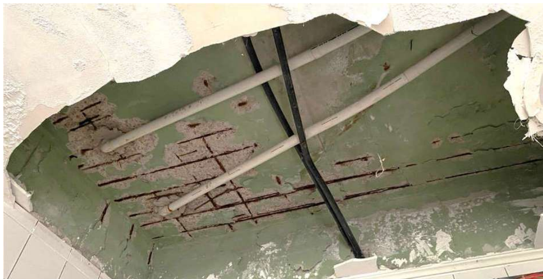
Figura 25: Armadura exposta e corroída em laje que abriga o banheiro.
