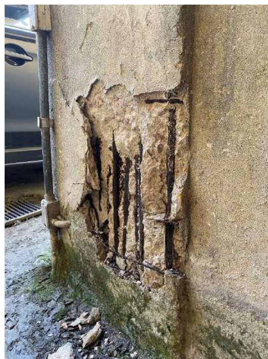
Figura 6: Armadura exposta e corroída na base de pilar.
