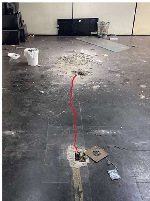
Figura 13: Fissura identificada no piso, 2º pavimento.
