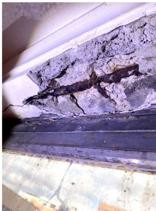
Figura 23: Armadura exposta e corroída em viga perimetral (fachada interna).
