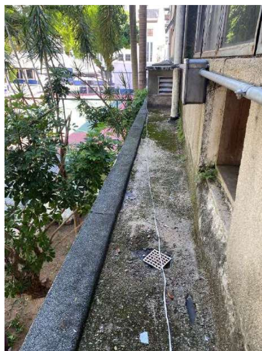
Figura 32: Presença de lodo em marquise.
