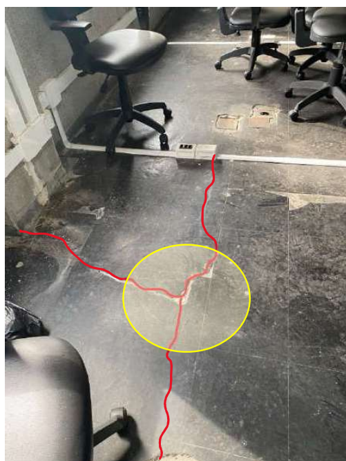
Figura 15: Fissura no piso coincidente com possível eletroduto embutido na regularização. Região em amarelo aberta posteriormente, consultar imagem ao lado.
