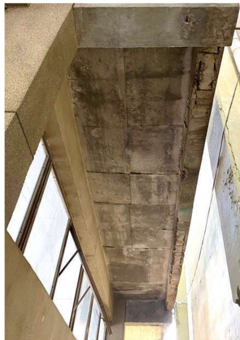
Figura 21: Deslocamento de concreto e armadura exposta em viga e laje da marquise.
