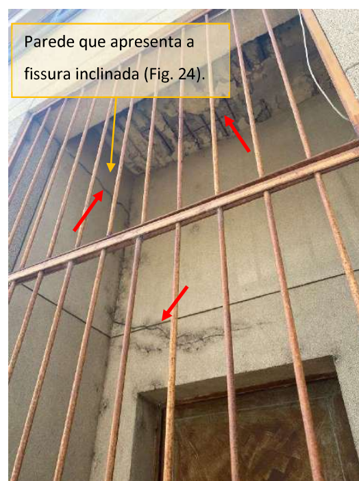
Figura 28: Presença de fissura em alvenaria e armadura exposta e corroída em laje.
