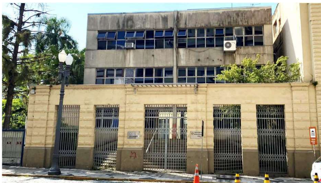
Figura 18: Fachada frontal, presença de lodo.
