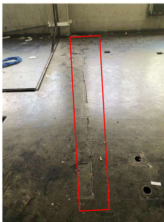
Figura 17: Fissura no piso coincidente com passagem de eletroduto.
