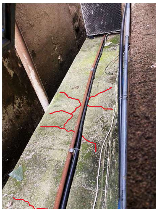
Figura 33: Marquise com presença de lodo e fissuras na impermeabilização.
