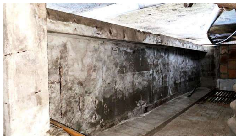
Figura 31: Armadura exposta e eflorescência em laje (marquise).
