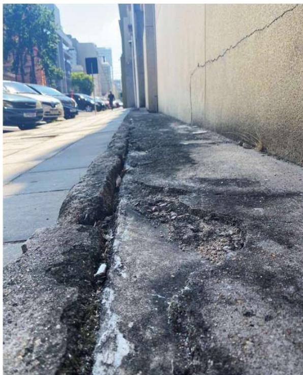
Figura 30: Afundamento de piso, calçada adjacente à alvenaria que apresenta fissuras.
