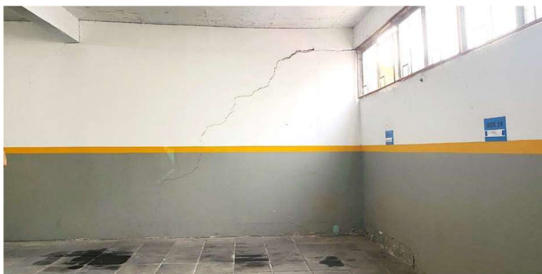
Figura 27: Fissura inclinada manifestada em alvenaria.
