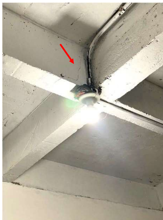
Figura 11: Fissura em viga.
