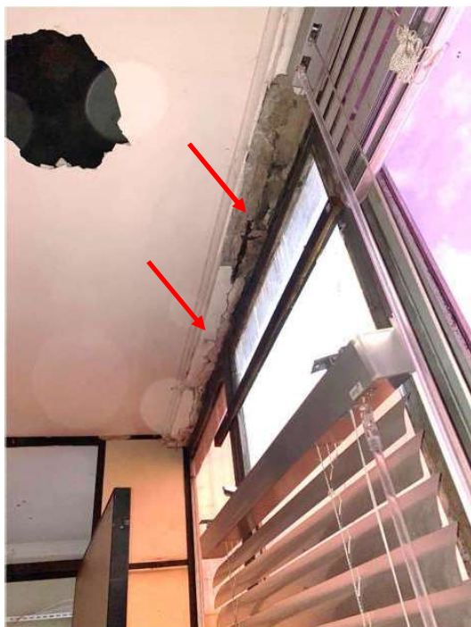
Figura 24: Presença de fissura e armadura corroída em viga perimetral (fachada interna).
