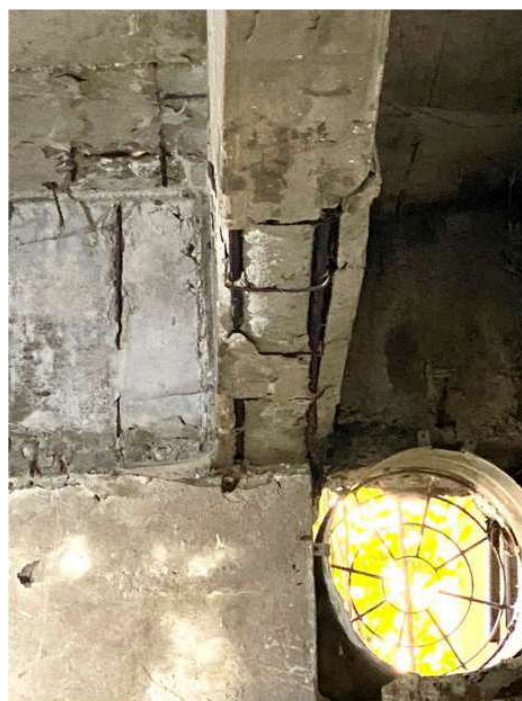
Figura 8: Armadura exposta e corroída em viga.
