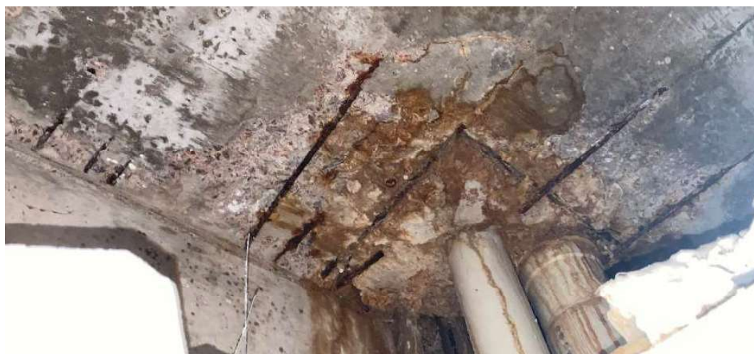
Figura 26: Armadura exposta e corroída em laje sob banheiro.
