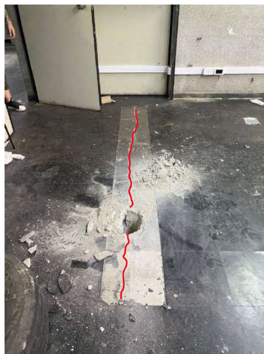
Figura 14: Fissuras identificadas no piso, 2º pavimento.
