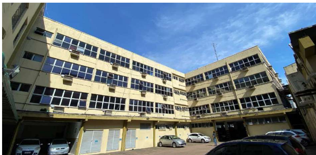
Figura 19: Fachada interna, presença de lodo e fissuras.
