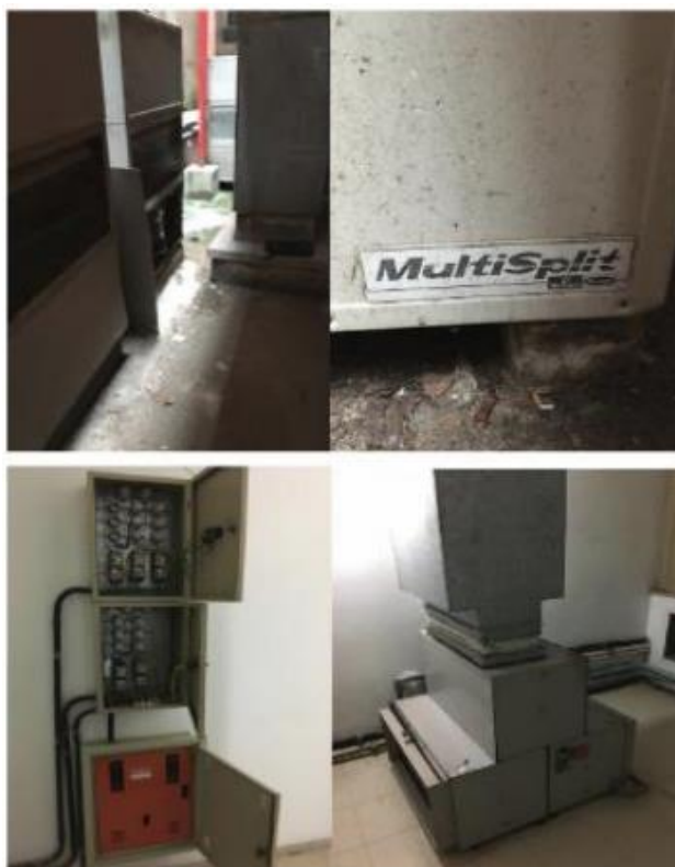
Figura 1 – Foto atual dos equipamentos e quadro elétrico.
