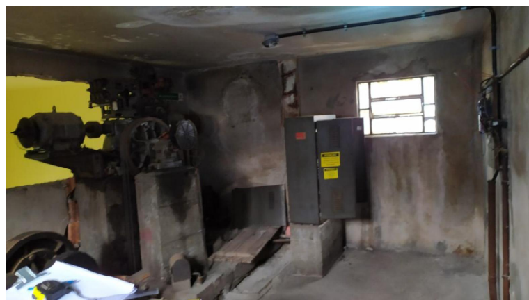
Imagem 2 – Vista interna da Casa de Máquina
