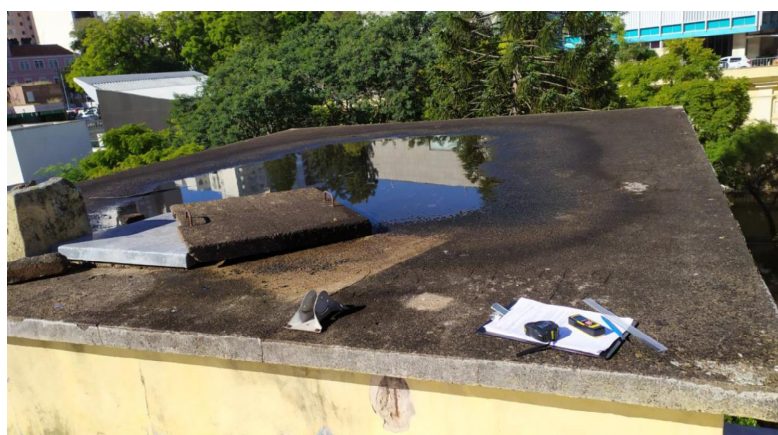
Imagem 11 – Reservatório Superior (Ausência de impermeabilização na laje de cobertura e no interior do reservatório)
