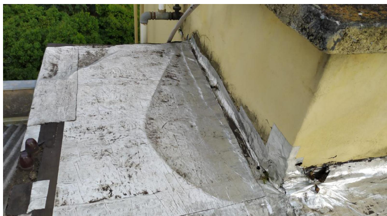
Imagem 9 – Laje da Casa de Máquina (sistema de impermeabilização ineficiente)
