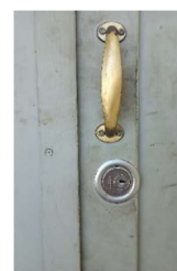
Fotografia 23 Fechadura autônoma vista pelo lado de fora da porta da casa de máquinas
