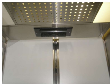
Fotografia 12 Cabina do elevador Schindler
