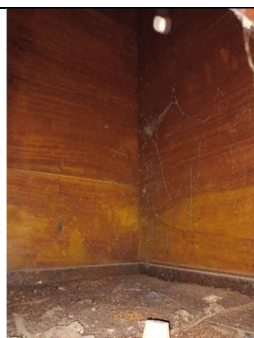
Fotografia 11 Cabina do elevador Otis
