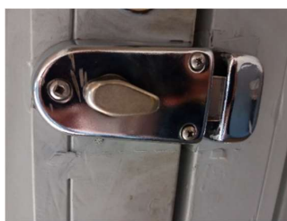
Fotografia 22 Fechadura autônoma vista pelo lado de dentro da porta da casa de máquinas
