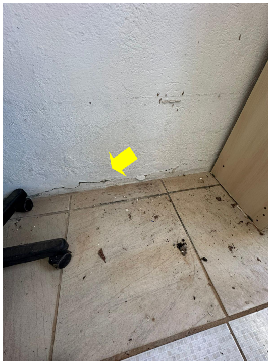
Foto 04: Parede interna c/ fissura aparente em sala de aula.
