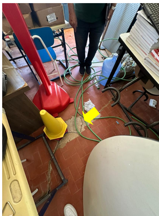
Foto 03: Piso de acesso ao local c/ fissura no piso.
