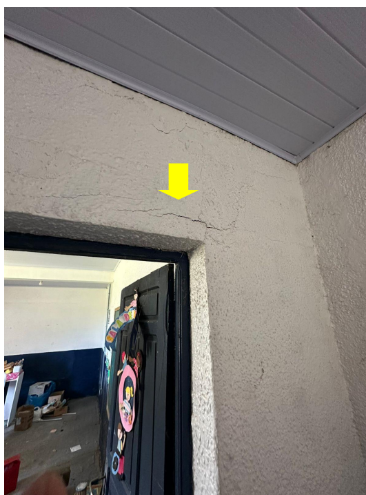
Foto 05: Parede interna c/ fissura aparente em depósito.
