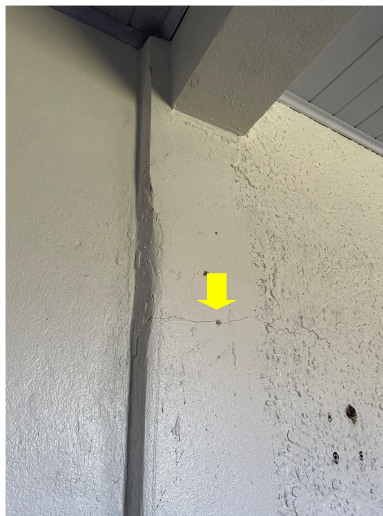
Foto 09: Fissura em parede do depósito. Fonte: Autor (2025).
