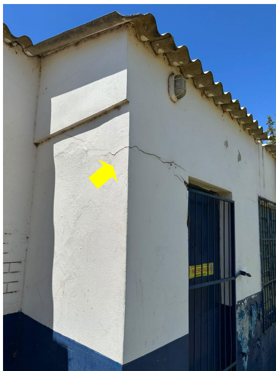
Foto 13: Parede externa c/ a presença de rachaduras.
