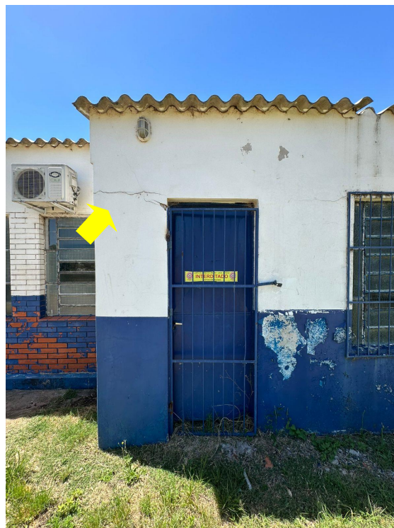
Foto 11: Parede externa c/ a presença de rachaduras.
