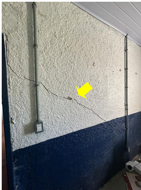
Foto 06: Parede interna c/ rachadura aparente em depósito.
