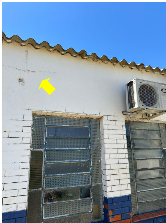
Foto 12: Parede externa c/ a presença de rachaduras.
