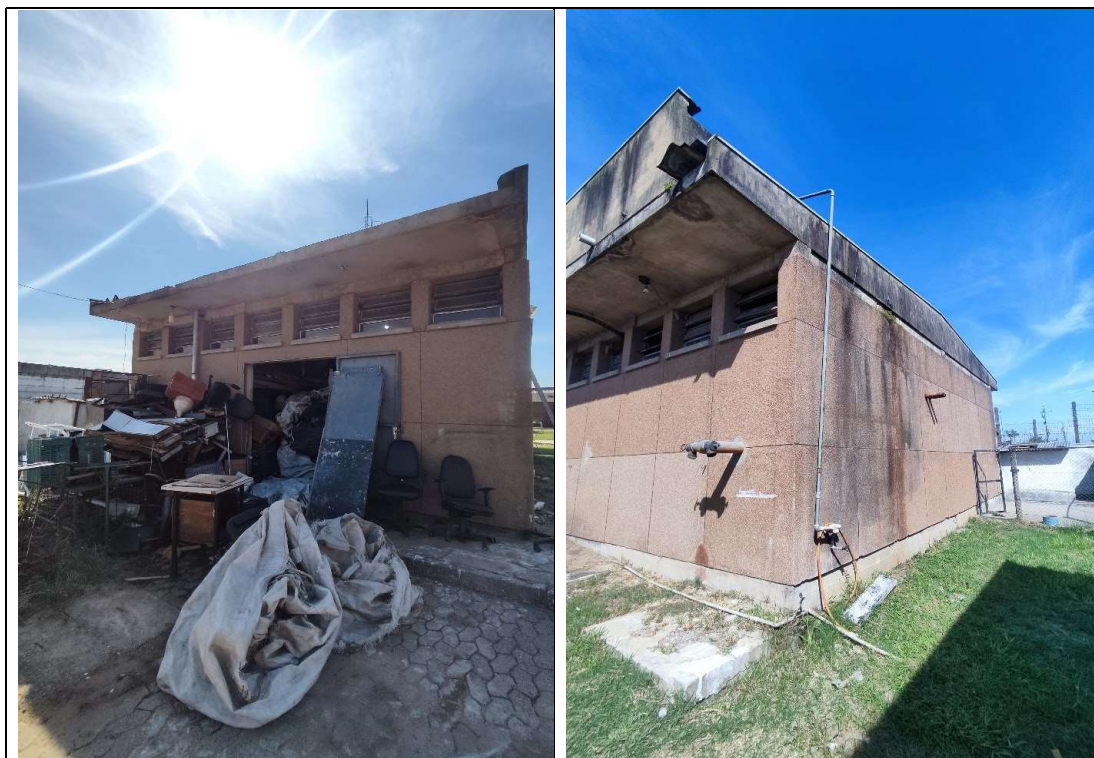
Figura 20 - Detalhe dos fundos da edificação e da lateral direita. Todas as aberturas deverão ser trocadas por modelos novos conforme orçamentos e memorial descritivo.
