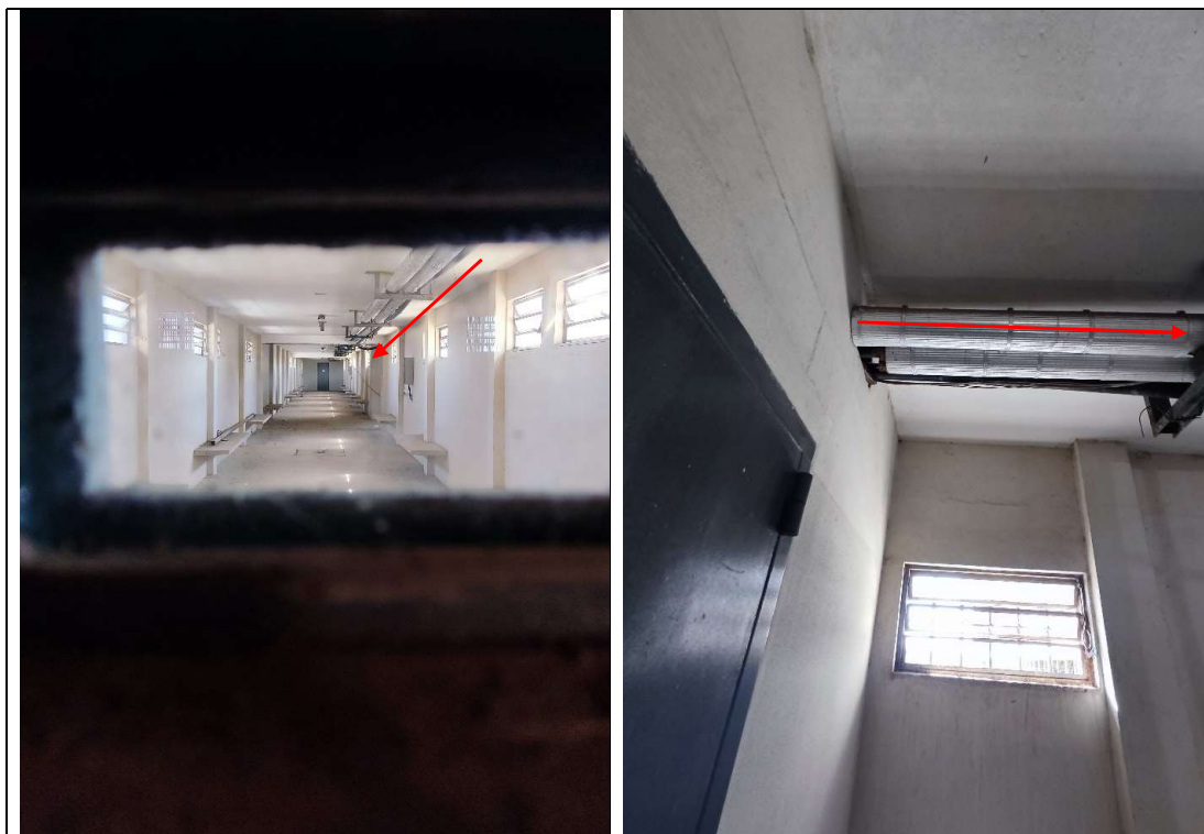
Figura 9 - Tubulação atravessando o tunel afixada ao teto e atravessando através das vigas já recortadas. Na foto a direita a tubulação sai do túnel para atender os dois andares das alas A e B.
