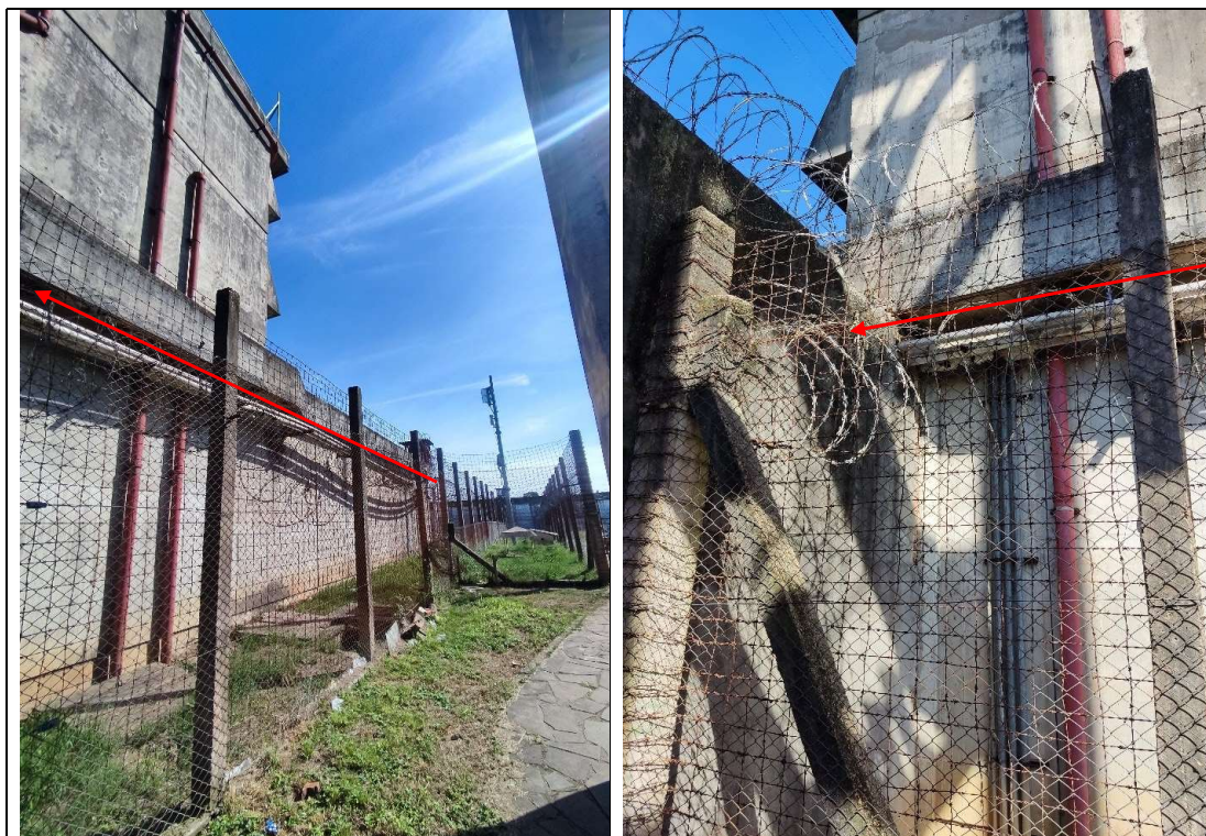
Figura 4 - Trajeto da tubulação afixado no muro da penitenciária e detalhe de onde a tubulação atravessa o muro através de furações na alvenaria e acessa o “pátio abastecimento” conforme indicado em planta baixa.
