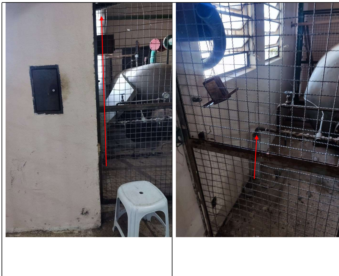
Figura 11 - Na figura a esquerda detalhe da tubulação de vapor atendendo o boiler do primeiro andar de celas dos pavilhões C e D e a subida atravessando a laje para o segundo andar do mesmo pavilhão. Na figura a direita observamos o ponto final da tubulação de vapor atendendo o boiler do segundo andar de celas. Estas fotos são o seguimento da tubulação depois de atravessar a laje e subir na figura de número 8.
