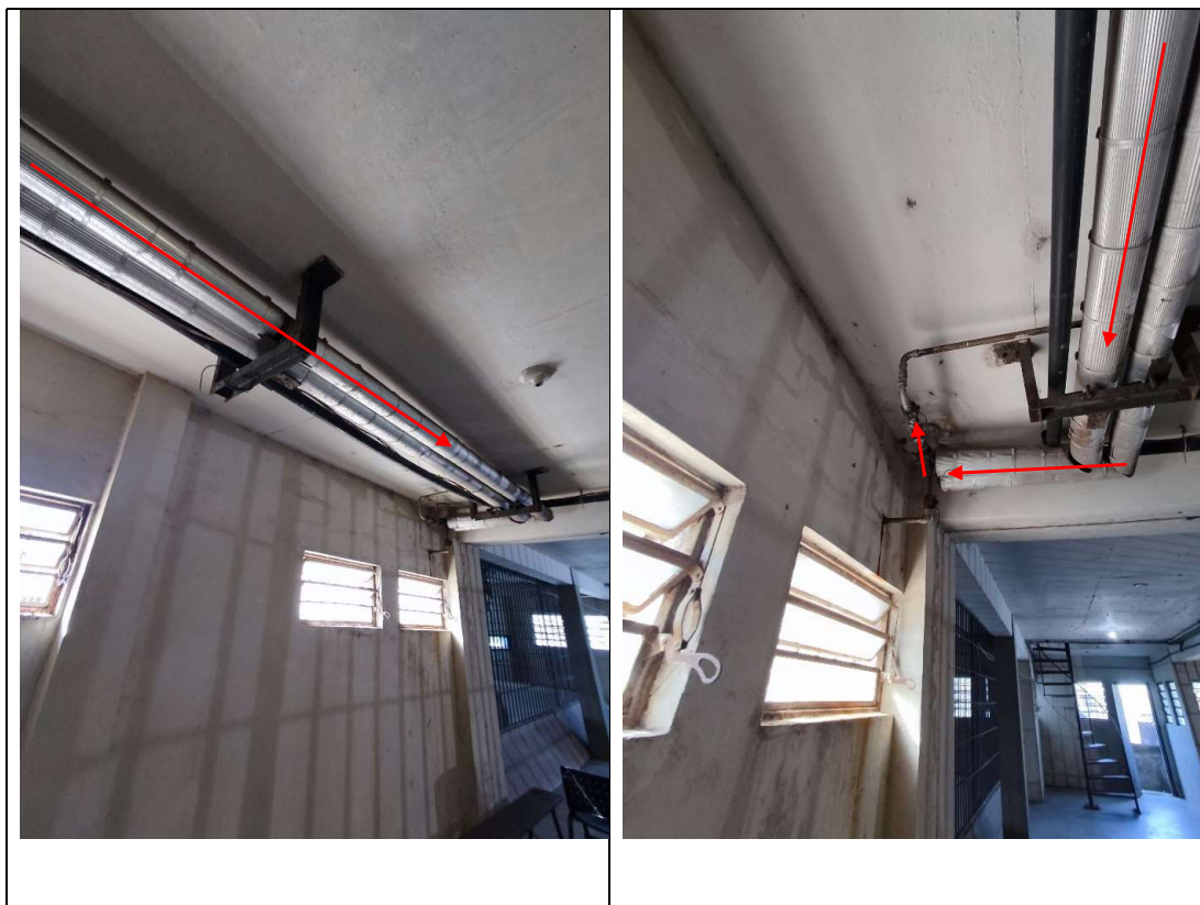
Figura 10 - Tubulação seguindo após a saída do túnel de passagem na figura à esquerda, afixada no teto e detalhe da curva e subida da tubulação para atender as alas A e B da penitenciária. As tubulações atravessam a laje e sobem diretamente para o primeiro andar de celas.
