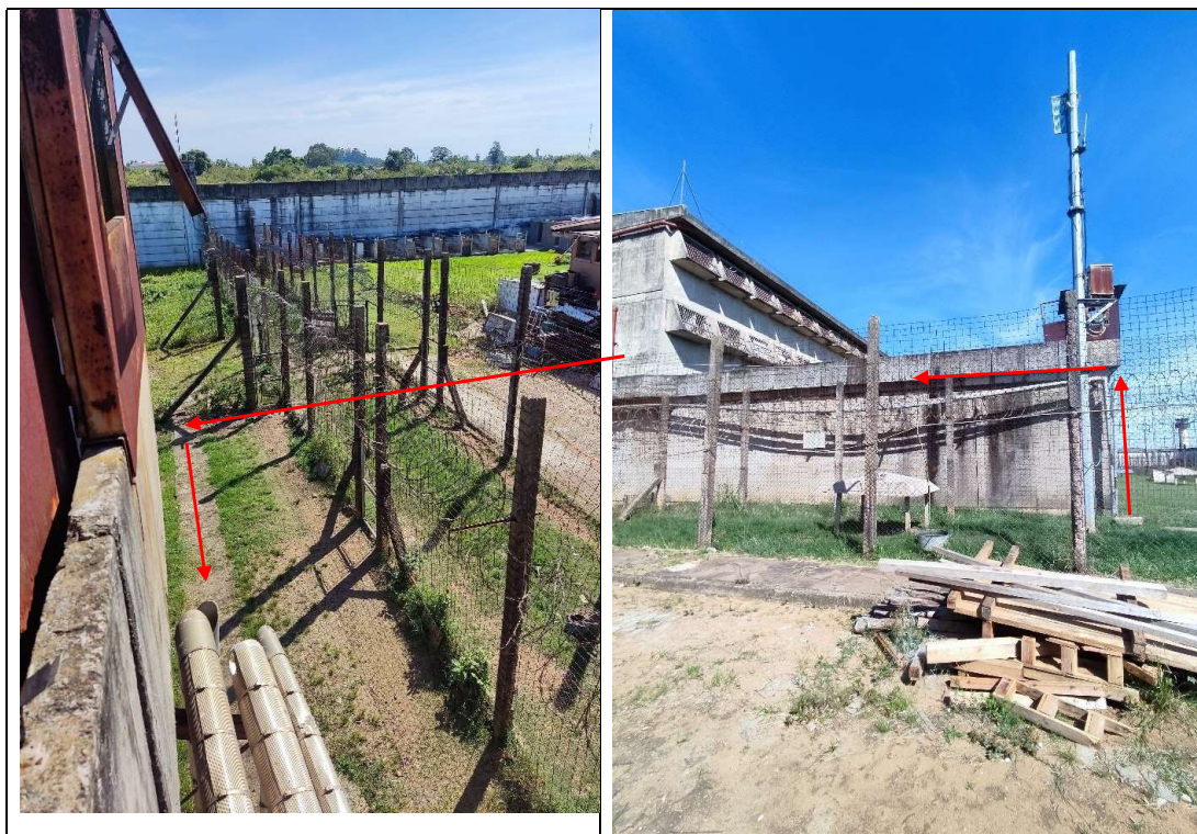
Figura 2 - Detalhe das subidas das tubulações de vapor saindo das valas com seguimento afixado no muro do pátio de esportes pela área externa.
