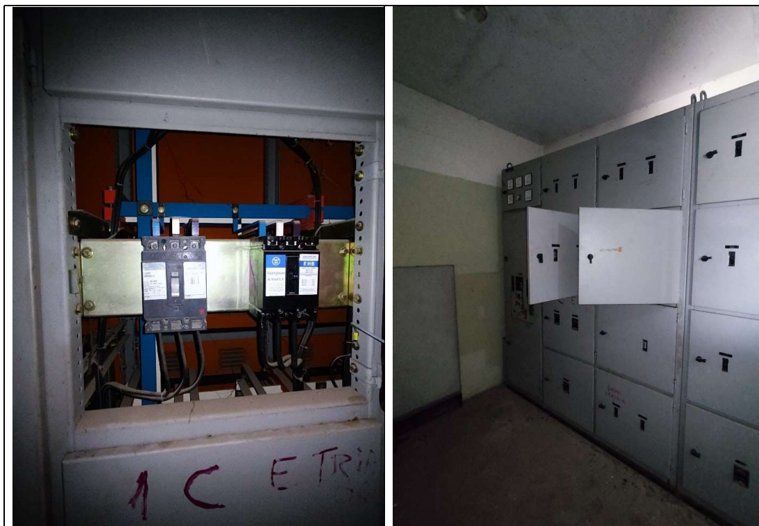
Figura 17 - Detalhe do barramento e disjuntor principal que atende a penitenciária e do abrigo dos barramentos com disjuntores na figura à esquerda.
