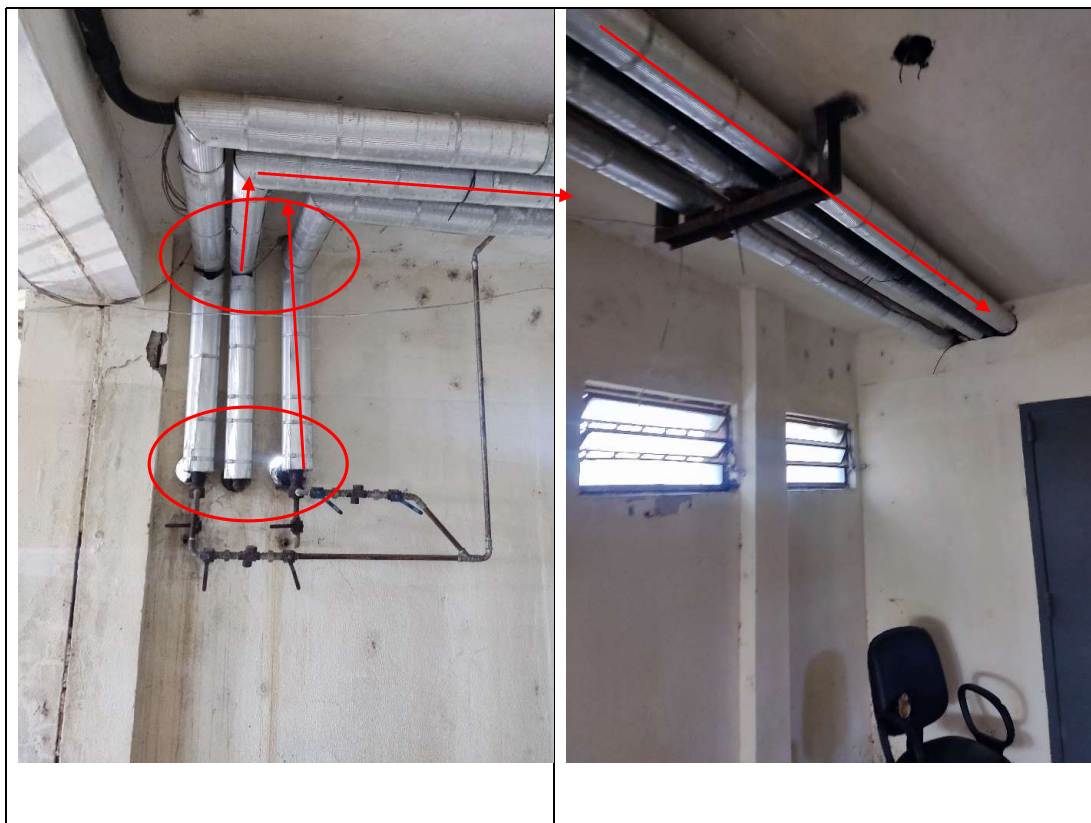
Figura 8 - Detalhe da tubulação vindo da área externa da penitenciária e o trajeto que ela segue para adentrar o túnel que irá atender os pavilhões A e B(figura da direita). Destacado também pelo círculo na parte superior da figura esquerda o ponto onde a tubulação ramifica e sobe através de furação na laje para atender as celas dos pavilhões C e D(figura da esquerda). O túnel comunica os pavilhões C e D aos pavilhões A e B pelo andar do mezanino.
