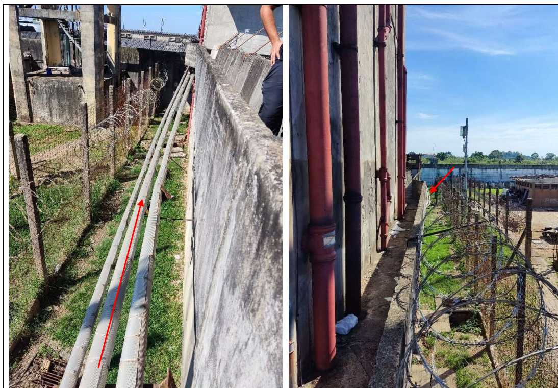
Figura 3 - Detalhe da tubulação junto ao muro onde pode-se verificar que as fixações estão se desprendendo e fortemente oxidadas. Na figura à direita pode-se verificar detalhe em outro ângulo com indicação por flecha da passagem da tubulação junto ao muro.
