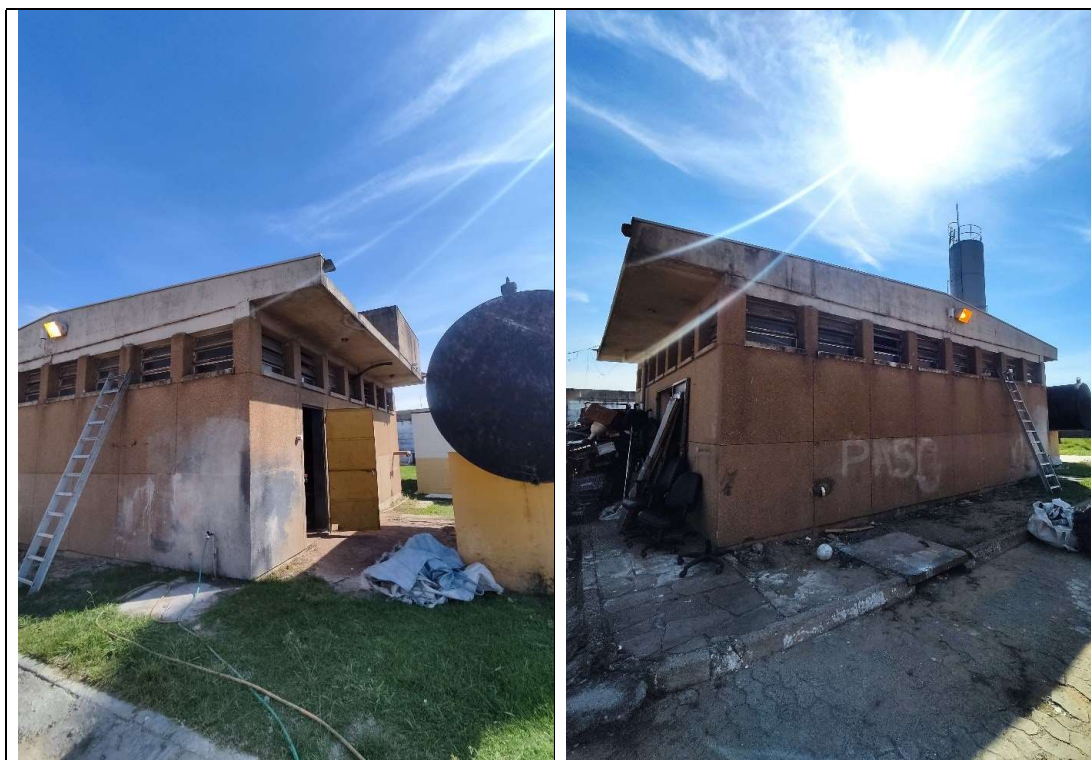
Figura 19 - Detalhe da frente da edificação com porta metálica e da lateral. Observa-se a necessidade de reformas gerais para renovação da edificação.
