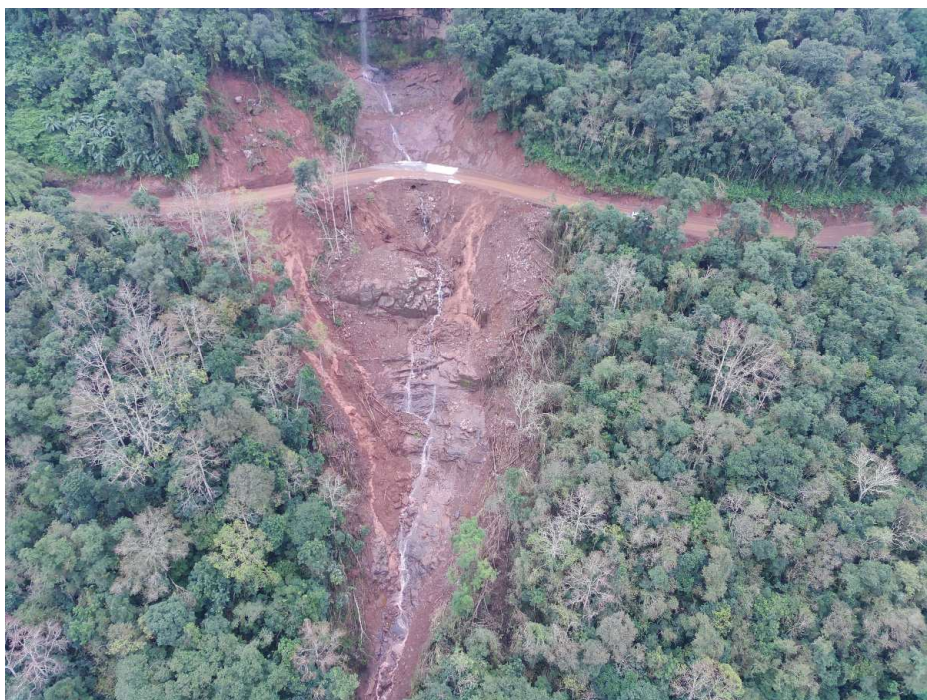
Figura 5: Patologia no pavimento - km 30+800
