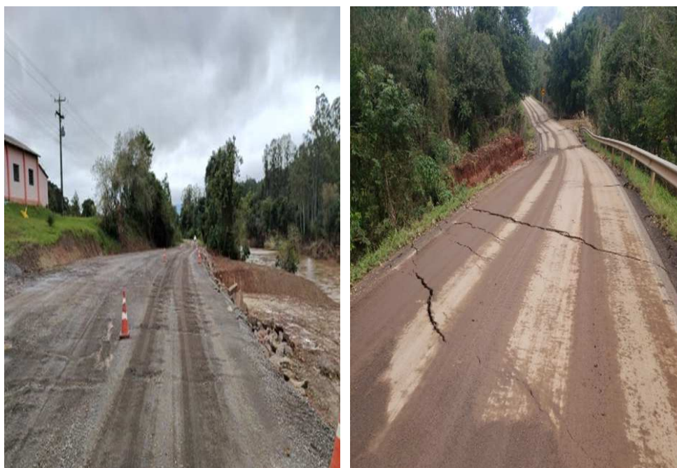
Figura 4: Escorregamento - km 148+900 Figura 5: Escorregamento- km 149+000 ao km 149+650
