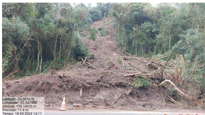
Figura 4: Deslizamento no km 21+770.
