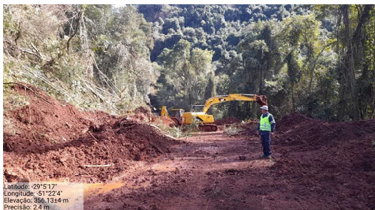
Figura 5: Patologia no pavimento - km 37+840
