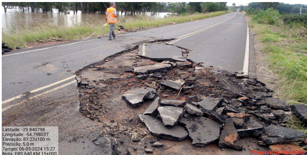
Figura 5: Deslocamento do pavimento - km 15+000
