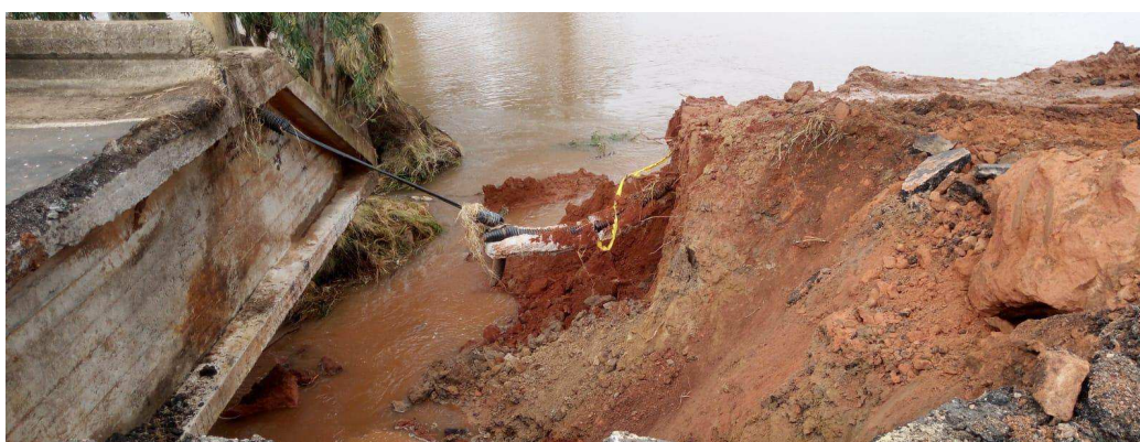
Figura 4: Rompimento cabeceira da ponte - km 15+500
