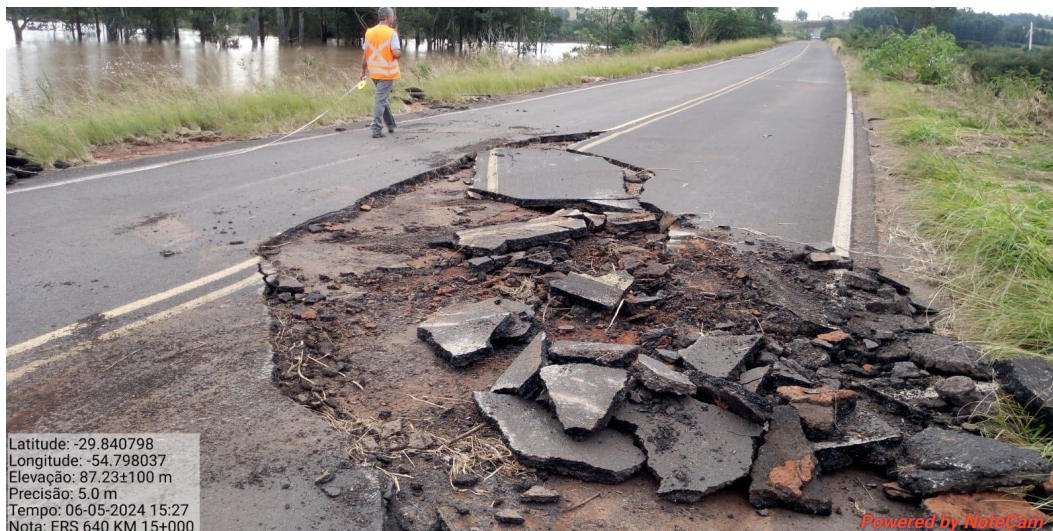
Figura 5: Deslocamento do pavimento - km 15+000
