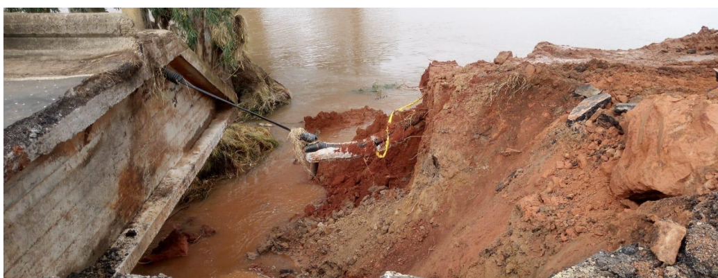
Figura 4: Rompimento cabeceira da ponte - km 15+500
