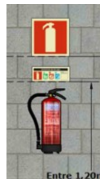
Detalhe da Sinalização básica de extintor.
