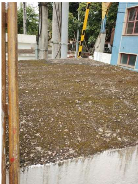
Foto 07 – Cabine norte – Impermeabilização a refazer
