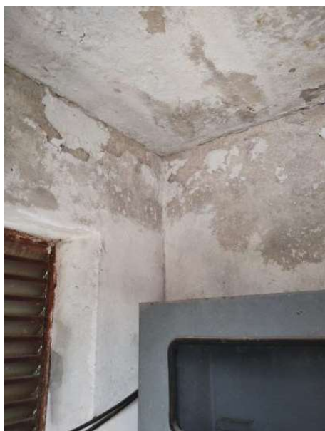
Foto 05 – Cabine sul – Laje a recuperar
