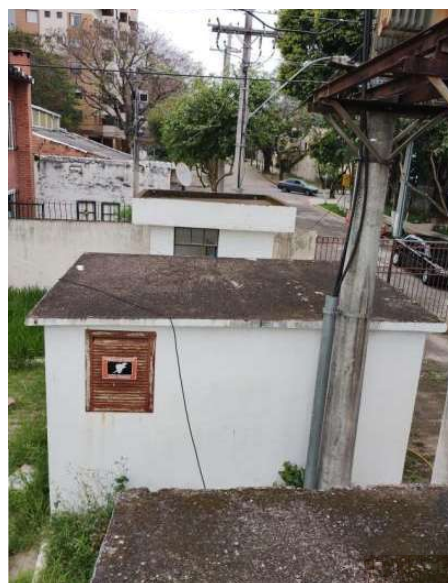
Foto 08 – Cabine sul – Impermeabilização a refazer
