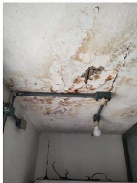
Foto 06 – Cabine sul – Laje a recuperar
