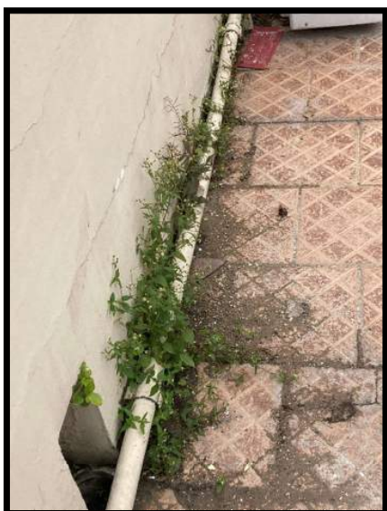
Figura 141: Vegetação parasitária em terraço denotando uma falha de manutenção.
