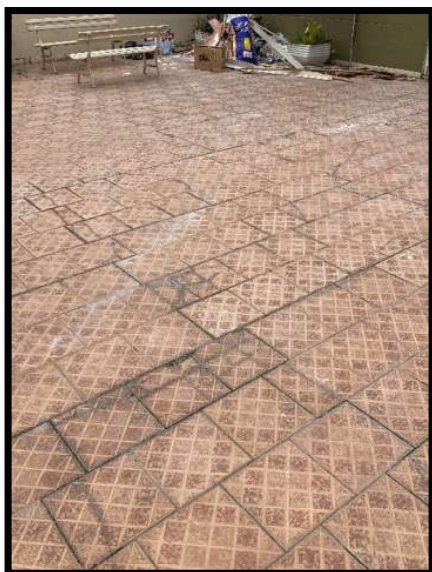
Figura 143: Revestimento cerâmico com avarias e falhas de aderência (som cavo) – terraço.
