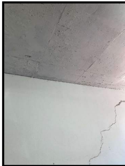
Figura 27: Desligamento entre elementos e fissura característica de recalque diferencial (estacionamento).
