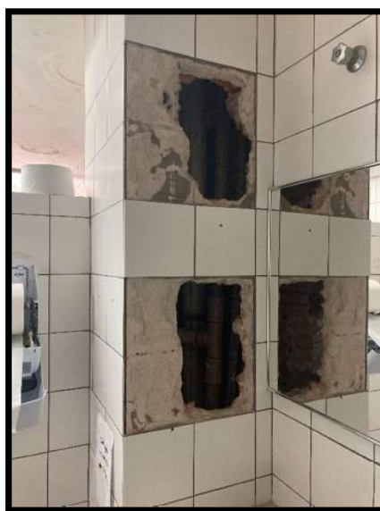
Figura 82: Remoção de azulejos e alvenaria de shaft – caracterizando uma falha de manutenção (sanitário feminino).
