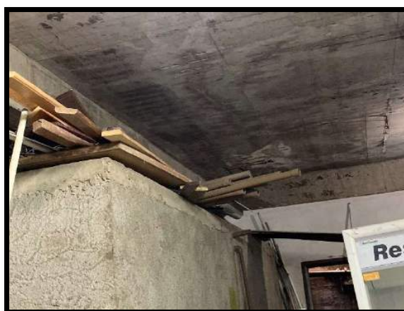
Figura 46: Armaduras longitudinais das lajes estão expostas e apresentando indícios de oxidação, corrosão, bem como umidade por condensação (depósito de materiais).
