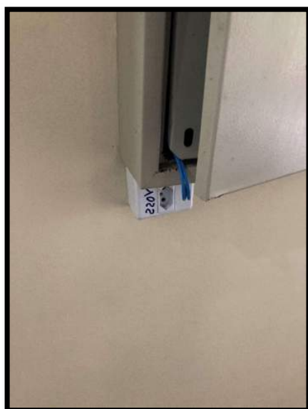
Figura 126: Cabeamento aparente, CD entreaberto e instalação irregular de tomada.
