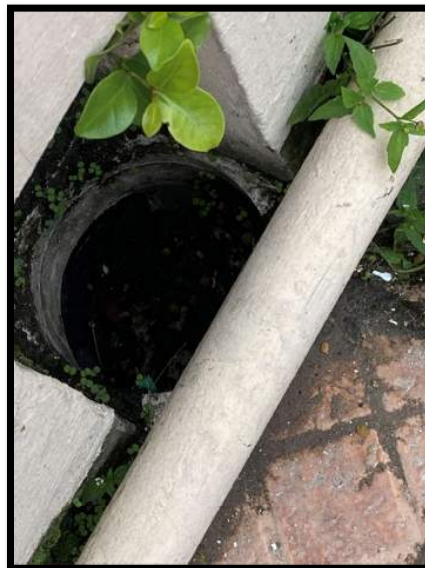
Figura 142: Tubo de queda pluvial parcialmente obstruído (terraço).
