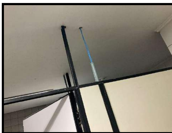
Figura 39: Fiação aparente (não tubulada) - sanitário masculino.
