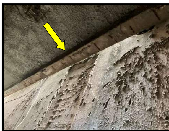
Figura 7: Idem Figura 6. Visualiza-se também o comprometimento de área considerável dos estribos (armaduras transversais).
