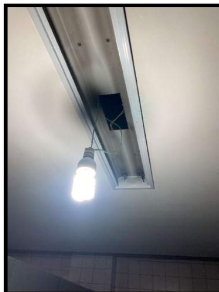
Figura 32: Fiação aparente – falhas de manutenção (vestiário masculino).
