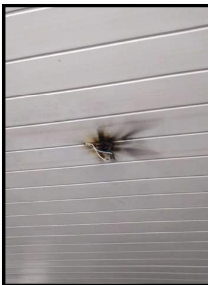
Figura 121: Ocorrência de curto-circuito em instalação elétrica de luminária de teto (Museu da BM).
