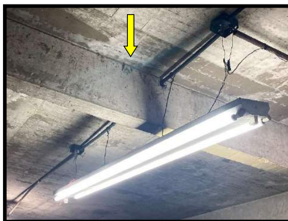
Figura 54: Desligamento entre elementos em concreto armado e instalações elétricas irregulares (depósito de materiais).
