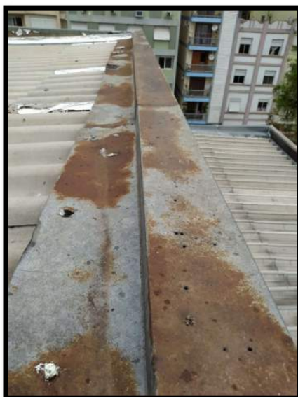
Figura 111: Incidência de corrosão e perfurações em rufos de capeamento – (cobertura da casa de máquinas do prédio 01).
