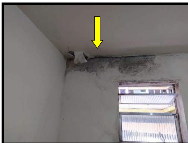
Figura 137: Indícios de infiltrações (recinto de empresa terceirizada de higienização).
