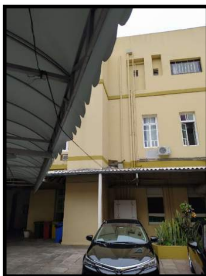
Figura 138: Instalações elétricas irregulares – cabeamento exposto e em contato direto com estrutura metálica, sendo, respectivamente, um material condutor.
