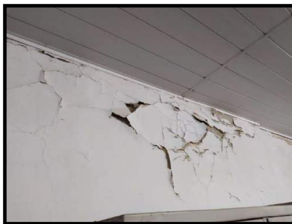
Figura 125: Descascamento da película de pintura, bem como indícios de revestimento com falhas de aderência ao substrato e indícios de som cavo (Museu da BM).
