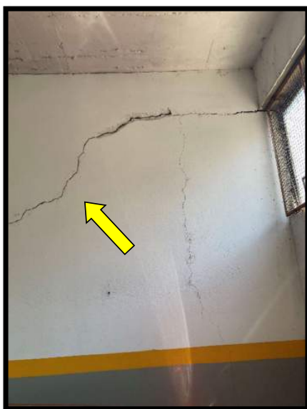
Figura 24: Fissuração característica de assentamento diferencial da alvenaria (estacionamento).
