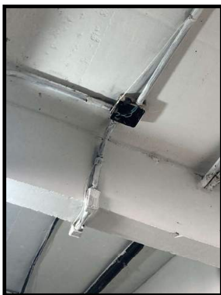
Figura 16: Fiação aparente – falha de manutenção (estacionamento).
