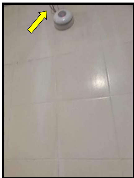
Figura 74: Fiação aparente (não tubulada) - sanitário masculino.
