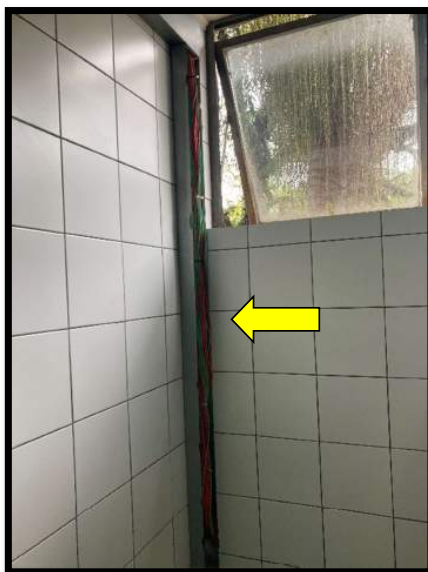
Figura 83: Fiação aparente (sanitário feminino).
