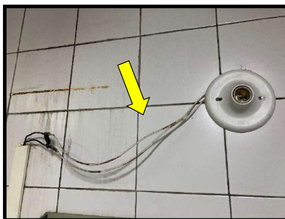
Figura 4: Fiação aparente (não tubulada) e emendas com falhas de isolamento (Alojamento dos Oficiais).
