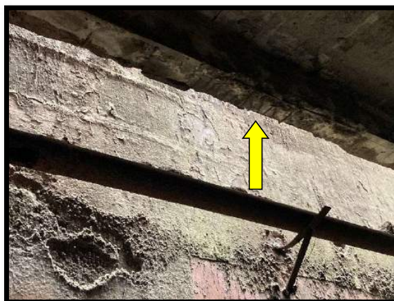
Figura 52: Corrosão junto às armaduras do vigamento de extremidade – e falhas de manutenção dos revestimentos (depósito de materiais).
