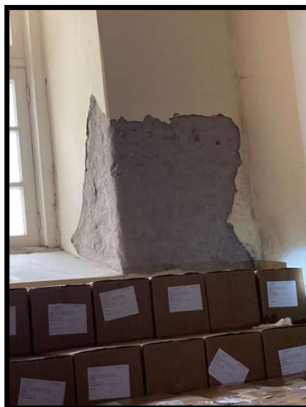
Figura 128: Revestimento interno sem película de pintura (sala PM3 / PROERD).
