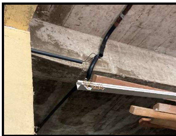
Figura 56: Armaduras expostas e instalações elétricas irregulares (depósito de materiais).
