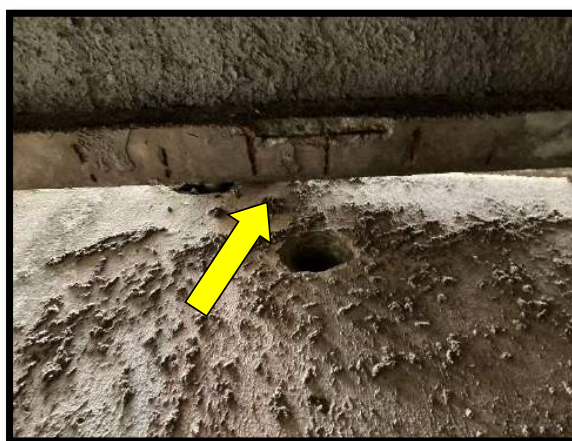
Figura 6: Armaduras expostas com indícios de corrosão e falhas de manutenção das fachadas em alvenaria (divisa entre prédios 1 e 2).
