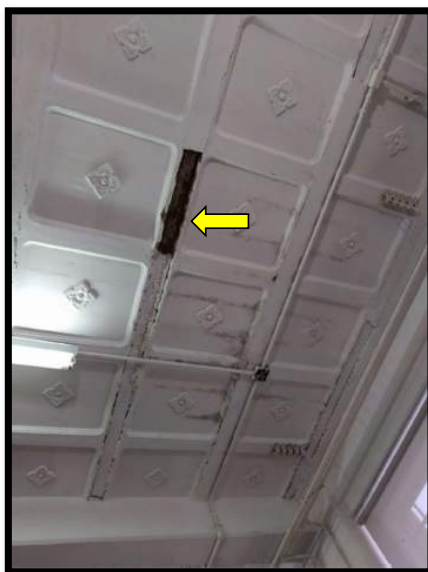
Figura 120: desprendimento do revestimento de teto, além da incidência de fissurações na extensão do mesmo em contato os perfis metálicos – risco aos usuários (Museu da BM).
