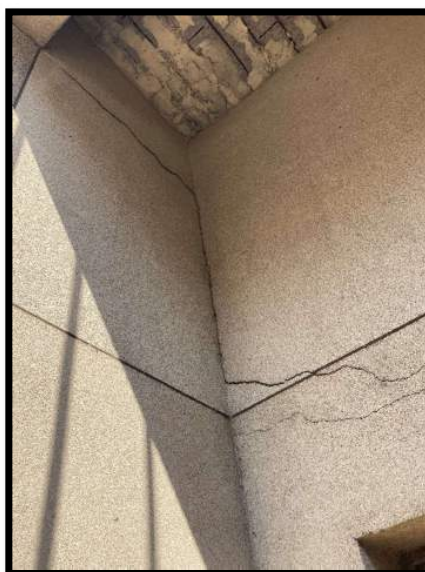
Figura 103: Fissuração atravessando a alvenaria – face oposta da figura 24.
