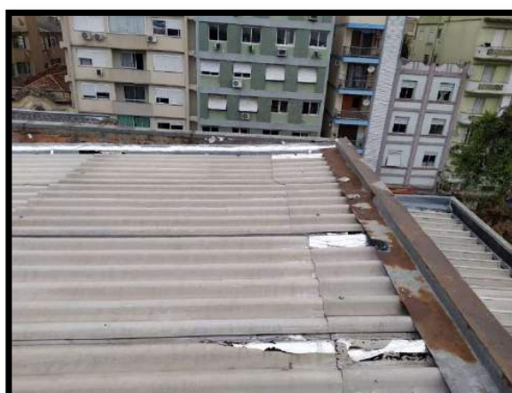
Figura 110: Rufos de capa avariados – oxidados, corroídos (em determinadas áreas) e apresentando perfurações – (cobertura da casa de máquinas do prédio 01).
