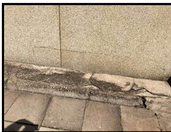
Figura 105: Fissuras em alvenaria e desintegração do revestimento.
