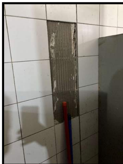
Figura 36: Deslocamento de revestimento cerâmico (vestiário masculino).
