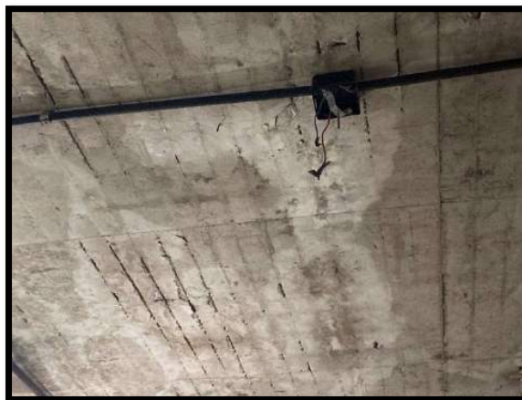
Figura 53: Armaduras longitudinais das lajes apresentando oxidação e corrosão, além do deslocamento da camada de cobrimento do concreto e fiação aparente (depósito de materiais).
