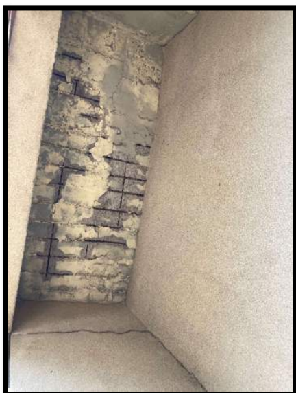
Figura 102: Armaduras longitudinais com indicadores de corrosão.
