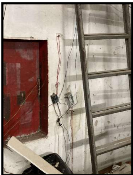
Figura 58: Fiação aparente e instalações elétricas irregulares (depósito de materiais).
