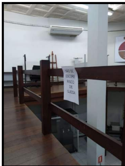
Figura 118: Guarda-corpos apresentando fragilidade mediante a aplicação de cargas horizontais – recomenda-se o atendimento à NBR 14718:2019 (Mezanino).
