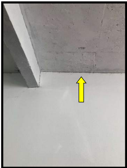
Figura 26: Desligamento entre elementos (estacionamento).
