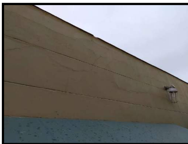
Figura 149: Fissuras geométricas e mapeadas apresentando falhas de aderência ao substrato (som cavo) – (fachadas do terraço).
