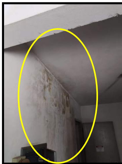
Figura 107: Infiltrações junto à parede limítrofe (sob os rufos de encosto) – casa de máquinas.
