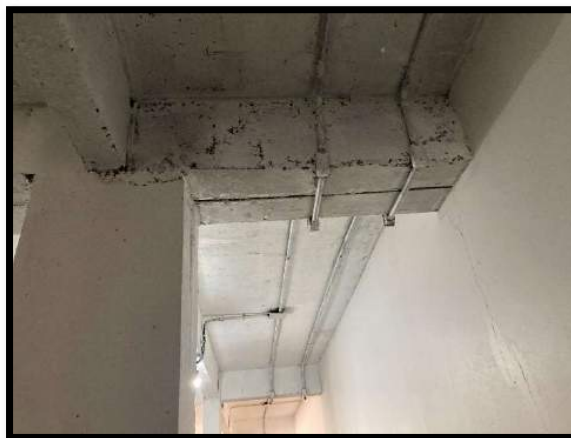
Figura 18: Nichos de concretagem e porosidade elevada dos elementos em concreto armado – ocasionando a redução da vida útil da estrutura (estacionamento).
