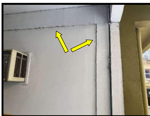
Figura 10: Desligamento entre os elementos - estrutura em concreto armado x alvenaria de vedação (estacionamento).
