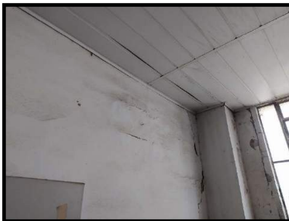
Figura 122: formação de bolhas em película de pintura e incidência de falta de aderência do revestimento argamassado – a percussão manual detecta sons cavos (Museu da BM).
