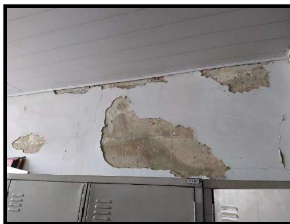
Figura 124: formação de bolhas e falhas de manutenção da película de pintura (Museu da BM).
