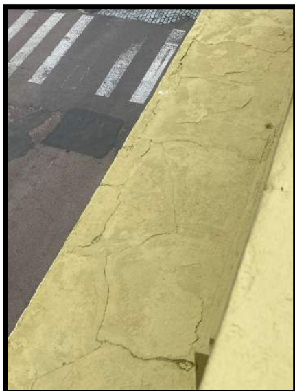
Figura 139: Fissuração e indícios de desgaste do revestimento (fissuras higro-térmicas) – falhas de manutenção.
