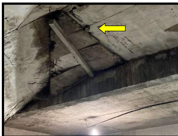
Figura 68: Armaduras expostas na laje. Ademais, a própria desforma da área não foi executada completamente (depósito de materiais).
