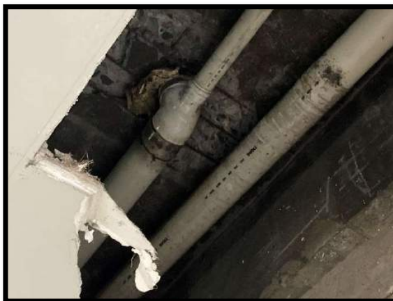
Figura 3: Armaduras expostas e corte em forro de placas de gesso para possível manutenção de outrora. (sala do alojamento dos oficiais).
