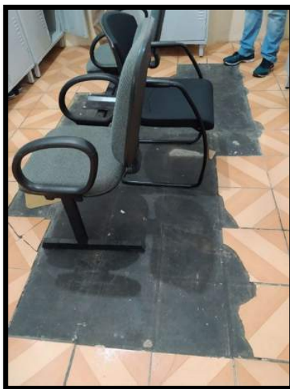
Figura 133: Falha de manutenção do piso cerâmico (vestiário).
