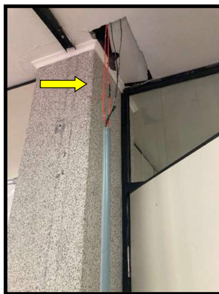
Figura 77: Fiação aparente (não tubulada) - departamento de informática.
