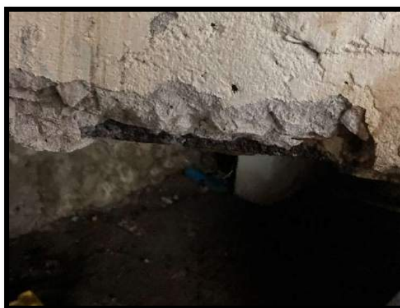
Figura 66: Idem Figura 65 – possuindo evidências do deslocamento de aproximadamente 3 cm de concreto motivados pela corrosão das armaduras (acréscimo de tensões).
