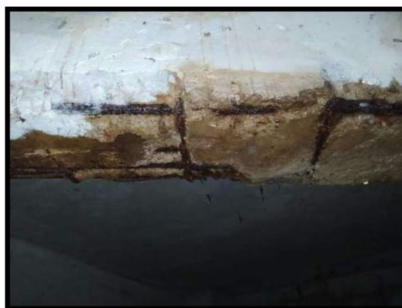
Figura 69: Corrosão das armaduras e alto teor de umidade (infiltrações e condensação) – depósito de materiais.
