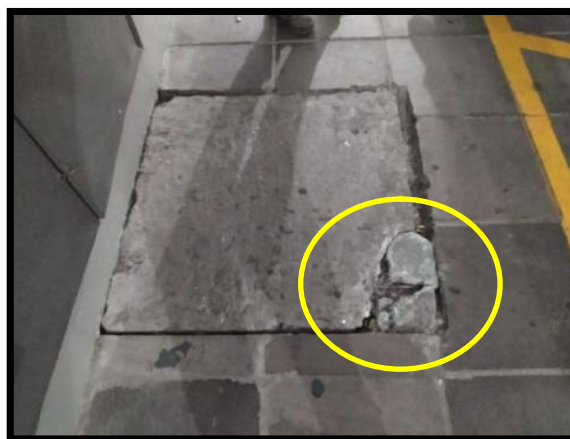
Figura 30: Caixa de inspeção com falhas de manutenção no que se refere à tampa (estacionamento).
