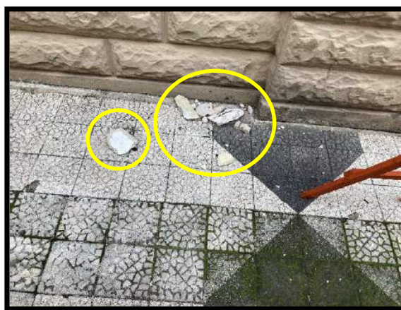
Figura 115: Fragmentos de revestimentos desprendidos da sacada situada junto ao passeio público – Rua dos Andradas – registrados em 05/10/2020.
