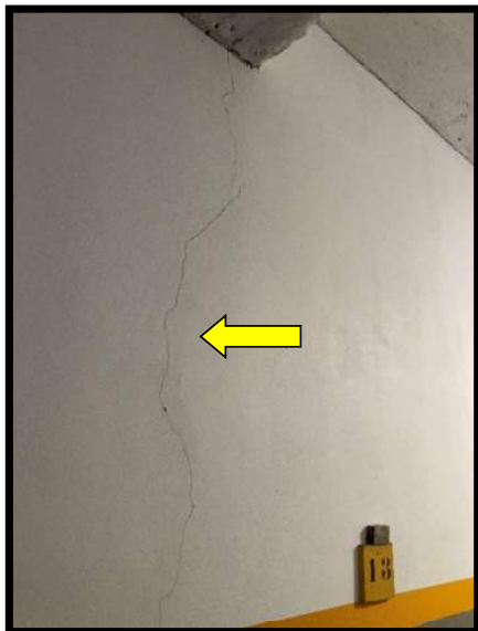
Figura 14: Fissuração no alinhamento das juntas de dilatação estruturais (estacionamento).
