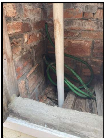
Figura 147: Acúmulo de entulhos junto à coluna de ventilação cloacal.
