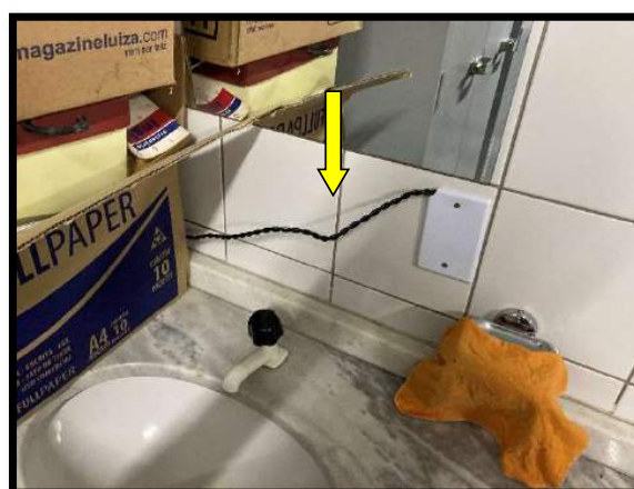
Figura 70: Fiação aparente e instalações elétricas irregulares (vestiário feminino).
