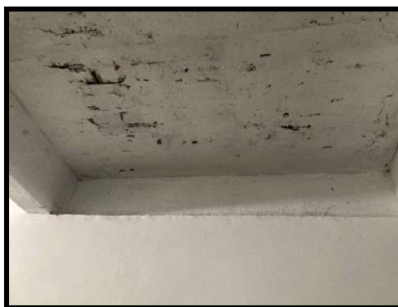
Figura 23: Cobrimento quase nulo das armaduras longitudinais das lajes – despassivação dos elementos em aço, corrosão e o deslocamento de camada de cobrimento em concreto (estacionamento).
