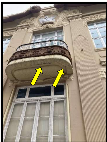
Figura 113: Sacada com fissuras e deslocamento do revestimento e camada de cobrimento em concreto.
