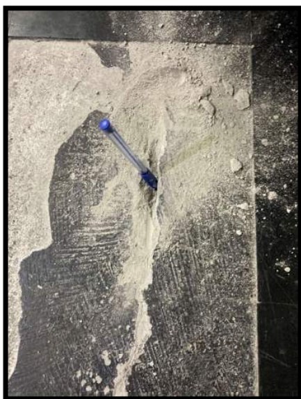
Figura 84: Fissura situada em laje de um dos recintos do 3º pavimento.
