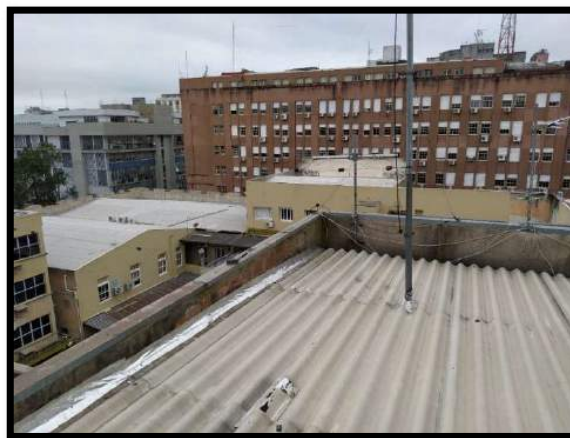
Figura 108: Ausência de rufos de encosto, capeamento avariado, e perfurações irregulares junto ao mastro Franklin e demais antenas – (cobertura da casa de máquinas do prédio 01).
