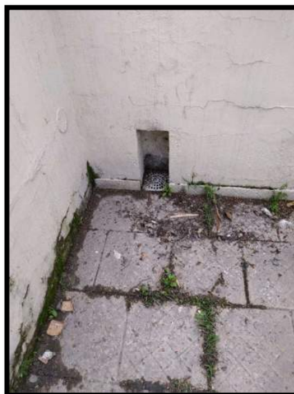
Figura 148: Falhas de manutenção e limpeza junto ao terraço – presença de vegetação parasitária.
