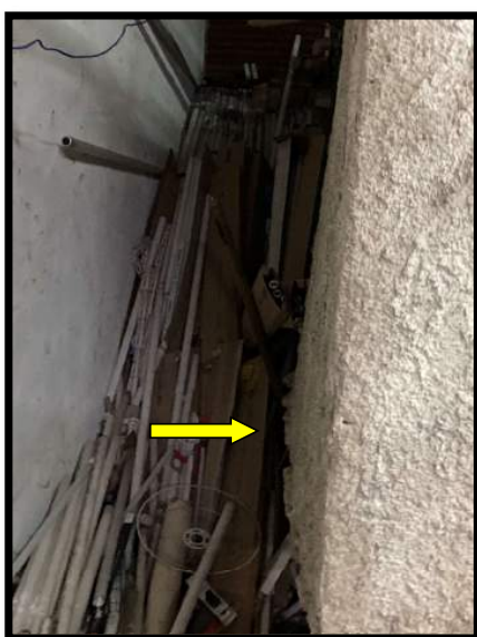
Figura 63: Deformação em estrutura de reservatório inferior desativado (depósito de materiais).
