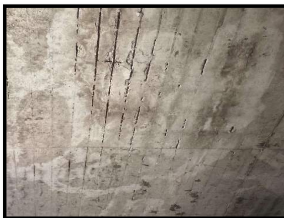
Figura 55: Armaduras expostas (depósito de materiais).
