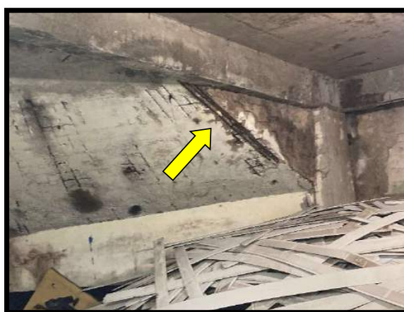
Figura 43: Armaduras expostas com indícios massivos de corrosão, infiltrações e umidade por condensação – sendo esta a estrutura da escada de acesso principal ao prédio 01. (depósito de materiais).
