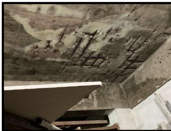
Figura 51: Idem Figura 46. Constata-se também a ocorrência de carbonatação.
