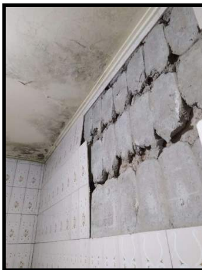
Figura 136: Deslocamento de azulejo (recinto de empresa terceirizada de higienização).
