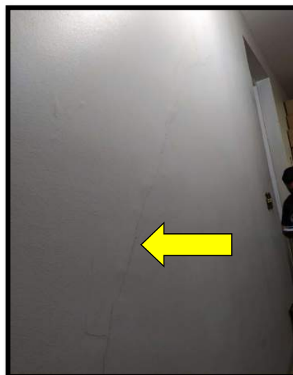
Figura 131: fissura sentido 45° - tipologia característica do assentamento diferencial das fundações (arquivo da BM).
