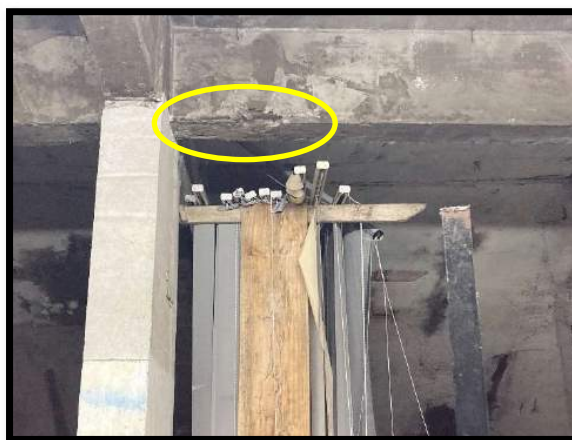
Figura 44: Armaduras expostas com indícios massivos de corrosão, infiltrações e umidade por condensação (depósito de materiais).
