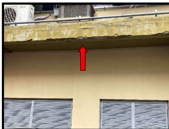
Figura 93: Armadura exposta apresentando corrosão e o deslocamento da camada de cobertura em concreto (marquise sobre o estacionamento descoberto).
