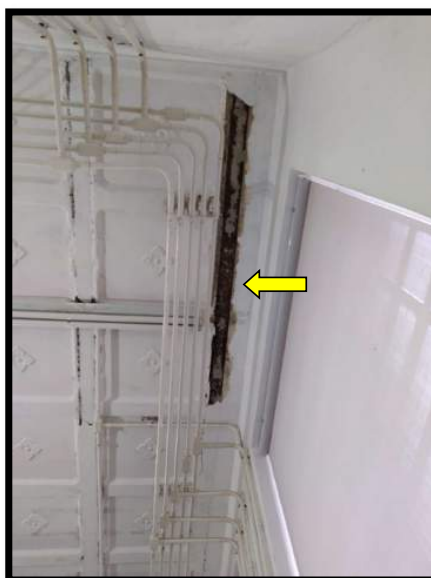
Figura 119: desprendimento do revestimento de teto – configurando risco aos usuários (Museu da BM).
