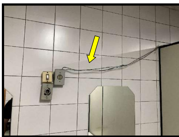
Figura 37: Fiação aparente (não tubulada) e instalações elétricas irregulares (sanitário masculino).
