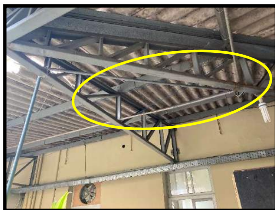
Figura 95: Instalações elétricas irregulares (fiação aparente em contato direto com material condutor de eletricidade – estruturas metálicas sem aterramento) e falhas de manutenção em relação à pintura das estruturas metálicas, de modo a diminuir a vida útil dos elementos (área de acesso entre prédios).
