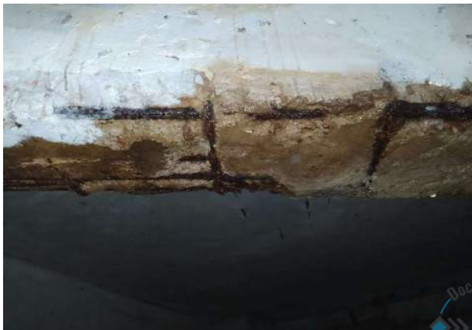
Corrosão das armaduras e alto teor de umidade (infiltrações e condensação) No depósito de materiais
