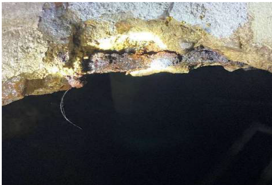
Armadura longitudinal de vigamento apresentado corrosão com perda significativa da área de aço (depósito de materiais)
