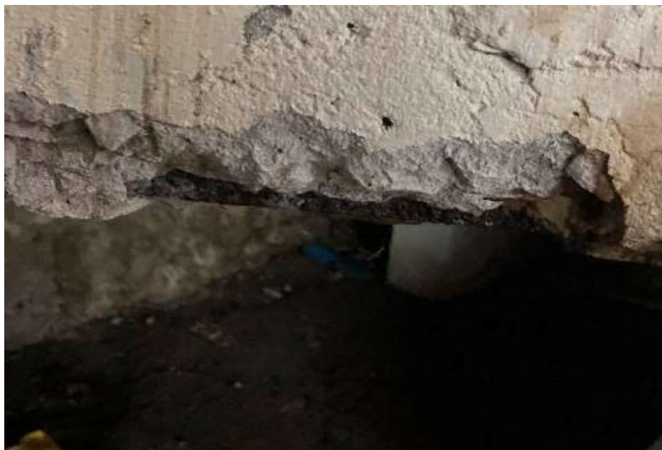
Possuindo evidências do deslocamento de aproximadamente 3 cm de concreto, Motivados pela corrosão das armaduras (acréscimo de tensões)
