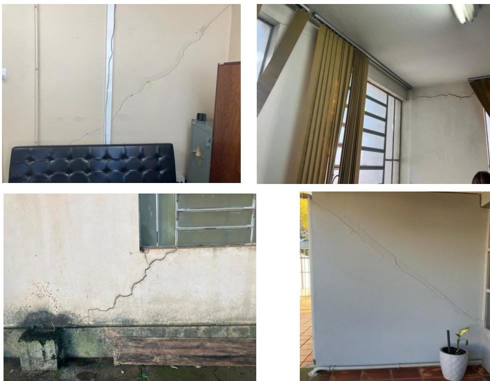
Fissuras/Trincas a serem reparadas
