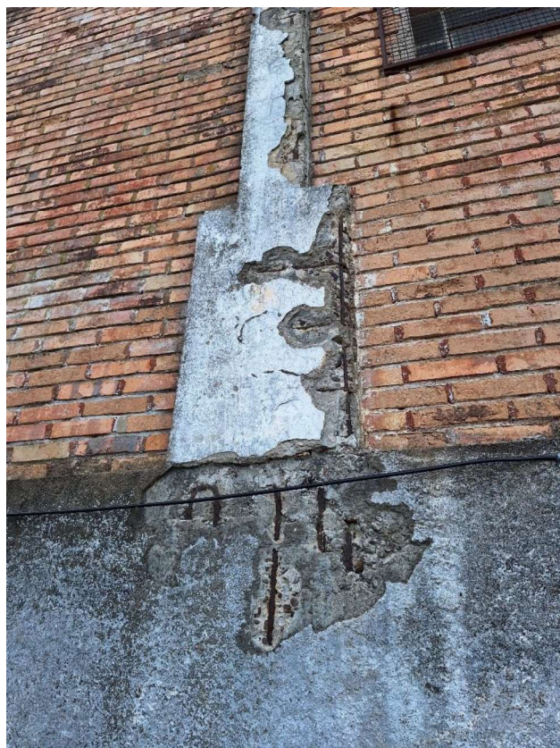
Foto 04- Armaduras expostas e apresentando indícios de oxidação, corrosão
