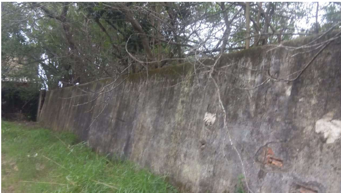
Muro com forte inclinação para o terreno da creche, as árvores deverão ser retiradas.
