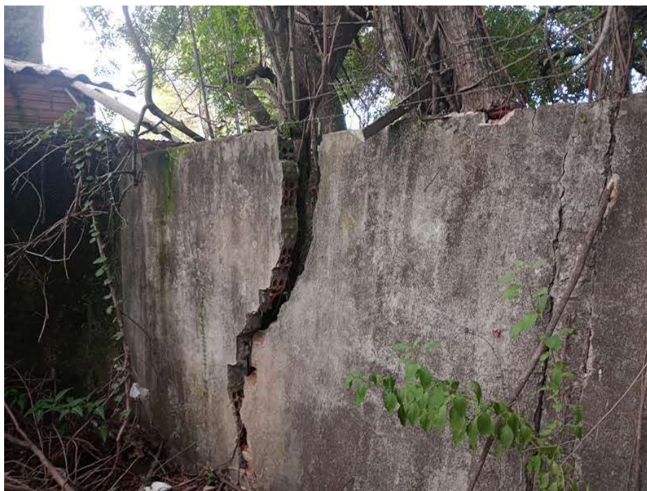
Muro de divisa a leste junto a creche Ao Neusa, apresenta forte tombamento para o terreno da creche, está escorado nas árvores.
