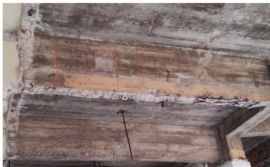
Foto 3b – Viga danificada 3
