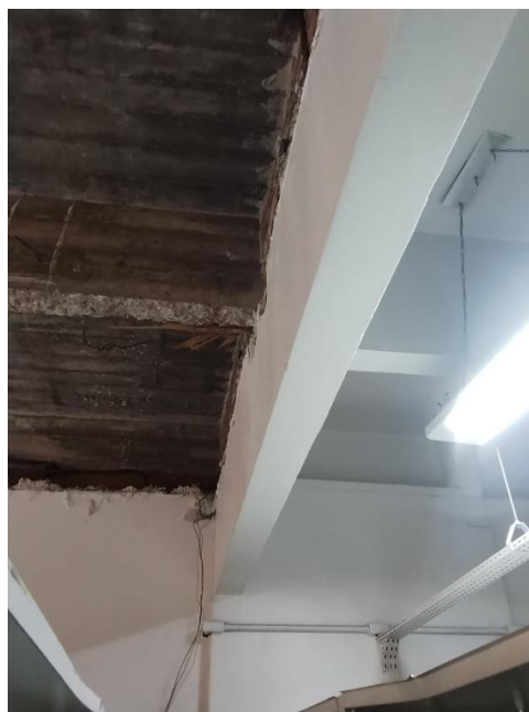
Foto 2b – Viga danificada 2
