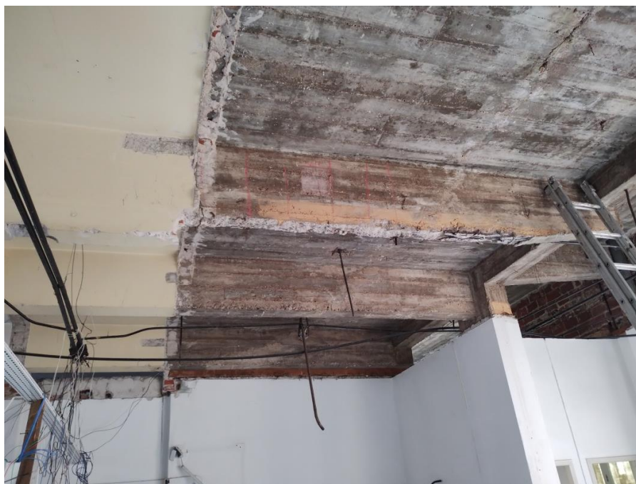
Foto 3a – Viga danificada 3
