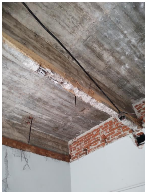
Foto 1a – Viga danificada 1
