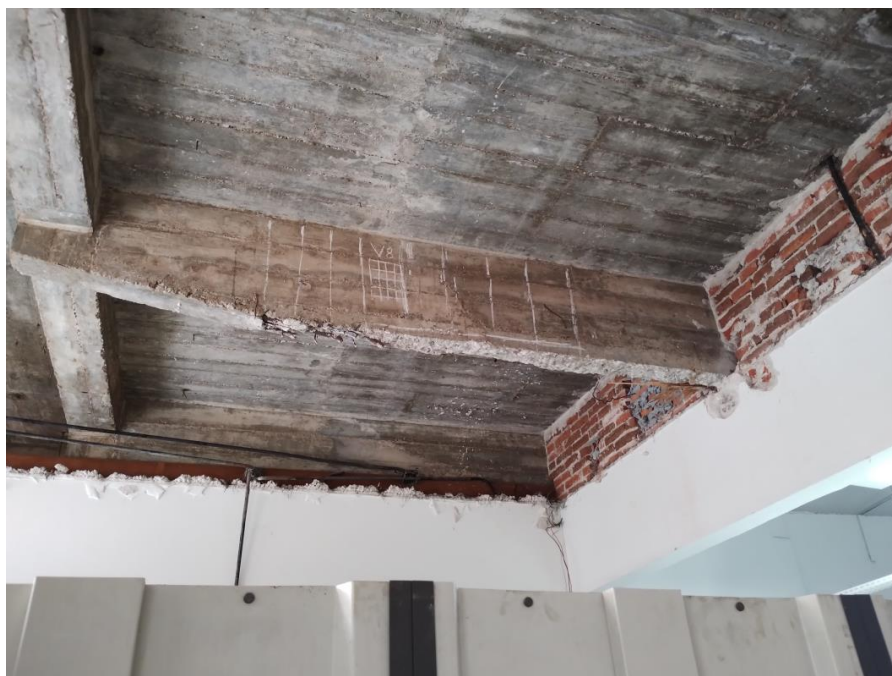
Foto 2a – Viga danificada 2
