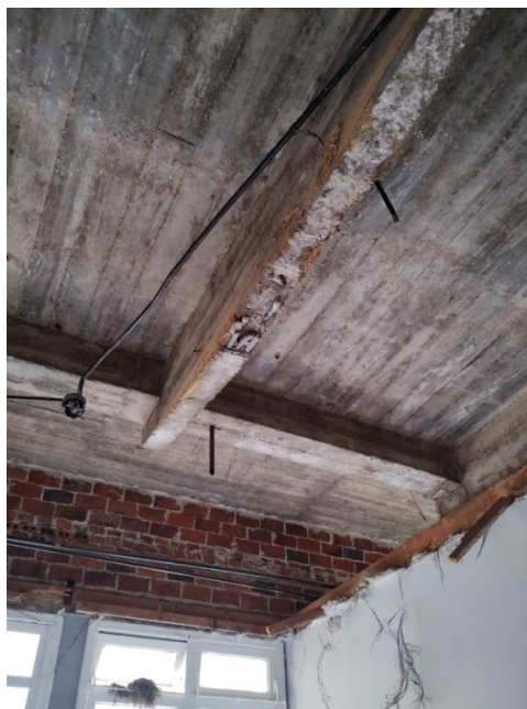
Foto 1b – Viga danificada 1
