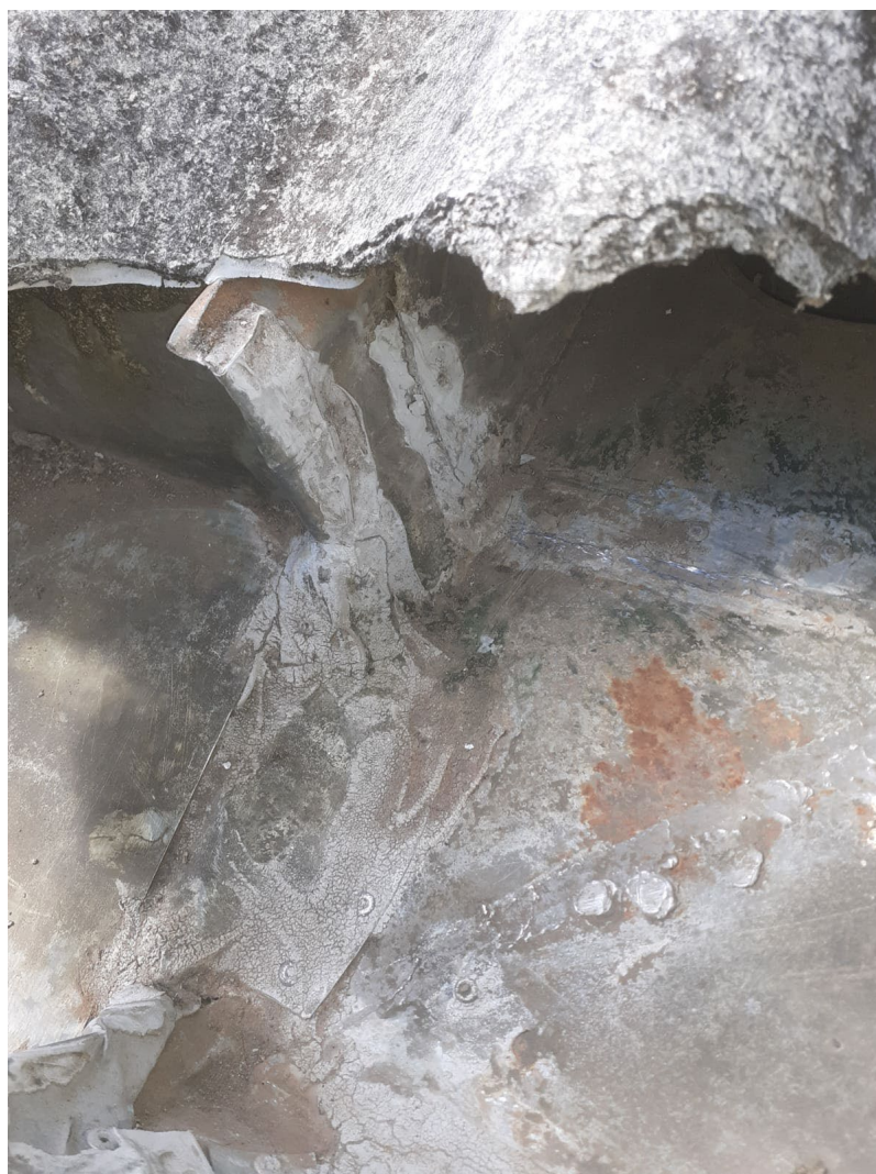
Imagem 02: Ponto de encontro de calhas com a impermeabilização vencida, podemos observar também o estado de decomposição das telhas fibrocimento com pontos de quebra.
