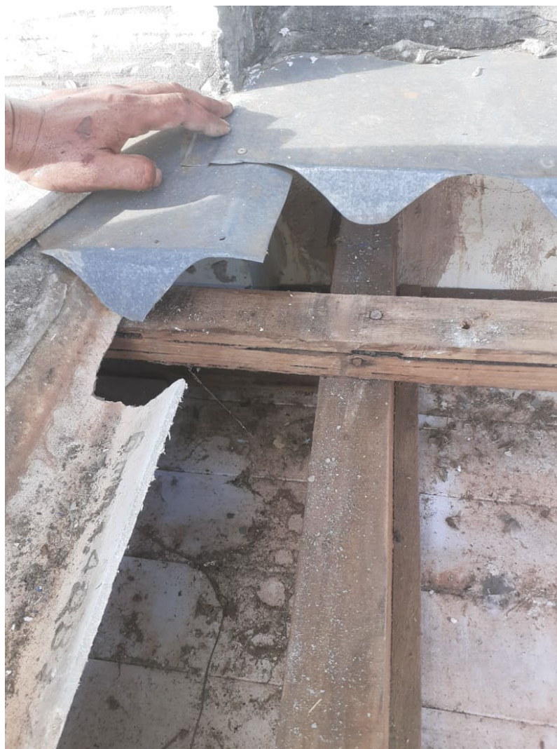
Imagem 04: Madeiramento com pontos de apodrecimento devido as constantes infiltrações agravadas pelas chuvas dos últimos meses.
