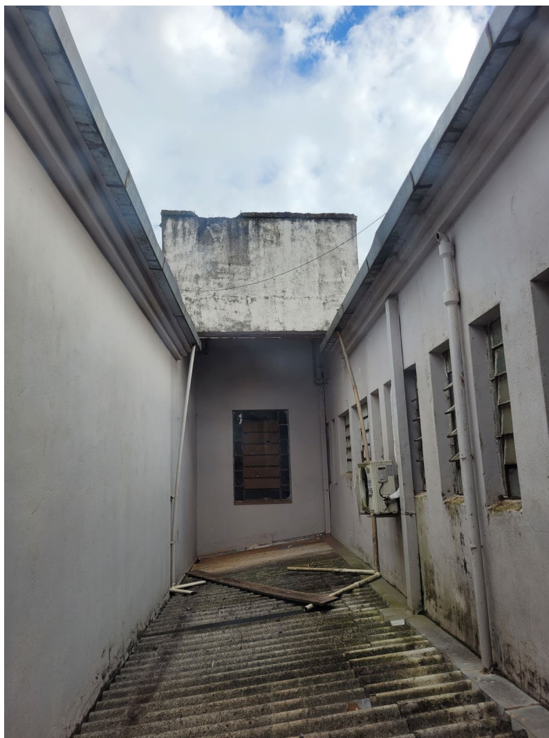
Imagem 06: Condutores de calhas desconectados, calha do coberto mais abaixo subdimensionada.
