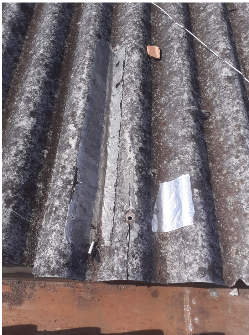
Imagem 03: Telhas deterioradas devido ao tempo de uso com fissuras e pontos de parafusos abertos, causando infiltrações para as salas abaixo.
