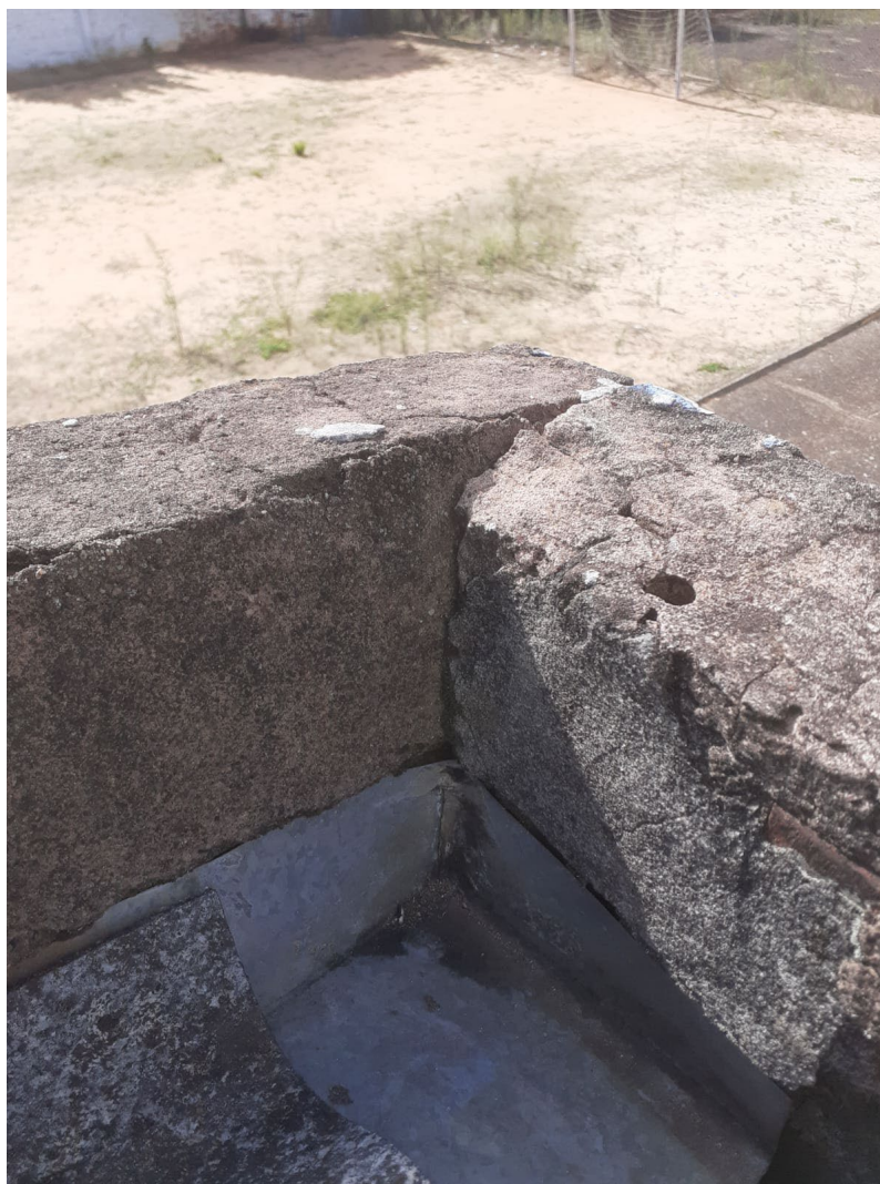
Imagem 01: Área sem manutenção adequada de reboco e impermeabilização acarretando ponto de Infiltração de água da platibanda para a laje.
