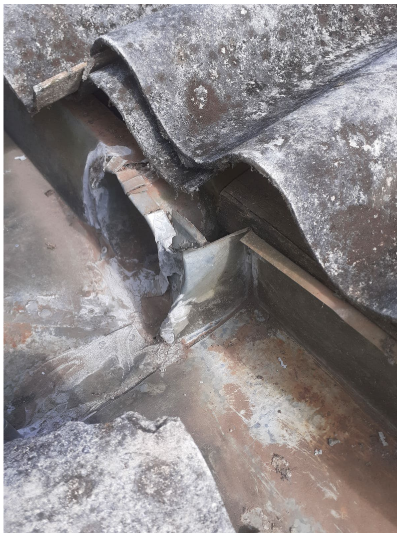
Imagem 05: Saídas de calhas deterioradas pelo tempo e falta de manutenção.
