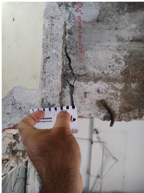
Foto 3c – Viga danificada 3 - Medição de 5mm na fissura
