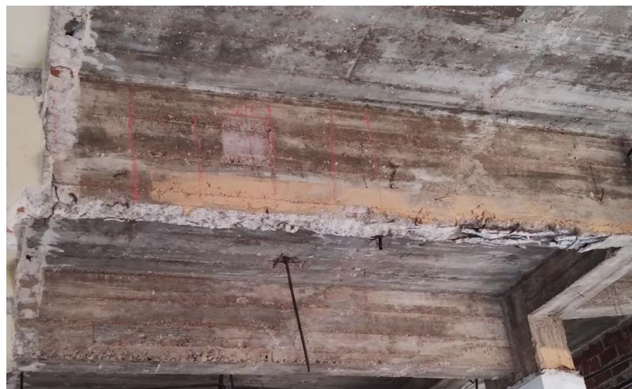
Foto 3b – Viga danificada 3
