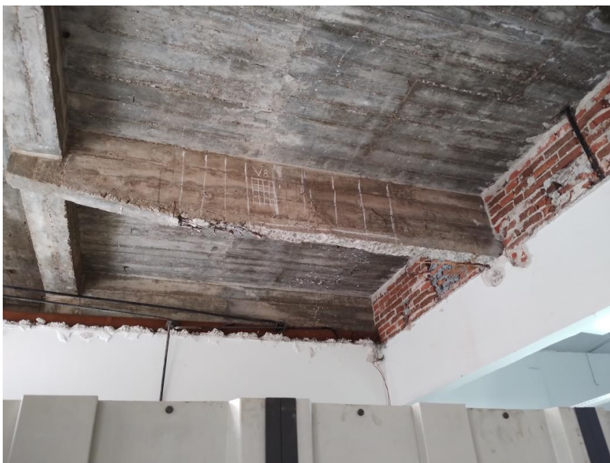
Foto 2a – Viga danificada 2
