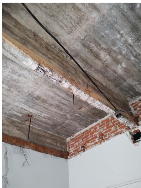
Foto 1a – Viga danificada 1
