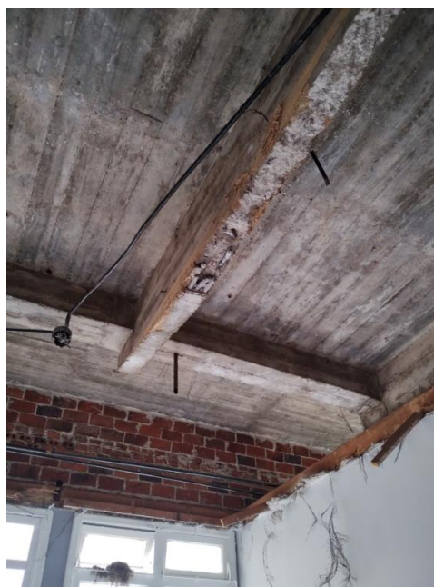
Foto 1b – Viga danificada 1
