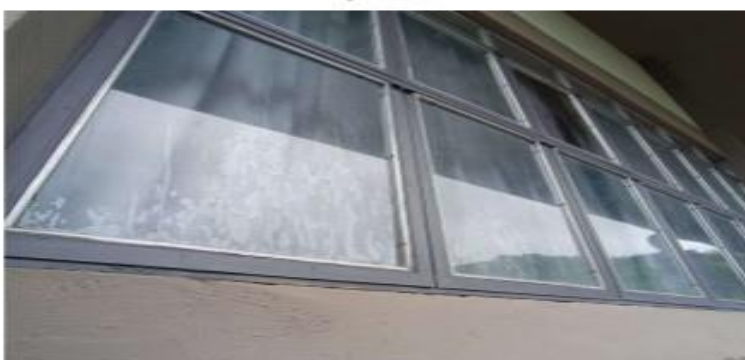
Imagem 04 – Situação de descolamento da película atualmente existente nas janelas da reserva técnica do MARSUL
