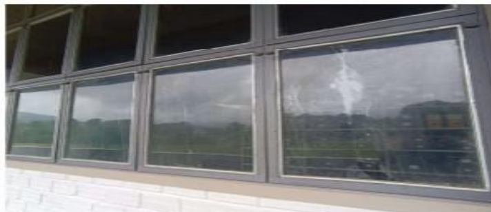
Imagem 01 – Situação de descolamento da película atualmente existente nas janelas da reserva técnica do MARSUL
