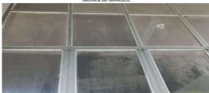
Imagem 02 – Situação de branqueamento da película atualmente existente nas janelas da reserva técnica do MARSUL, referente à sua deterioração
