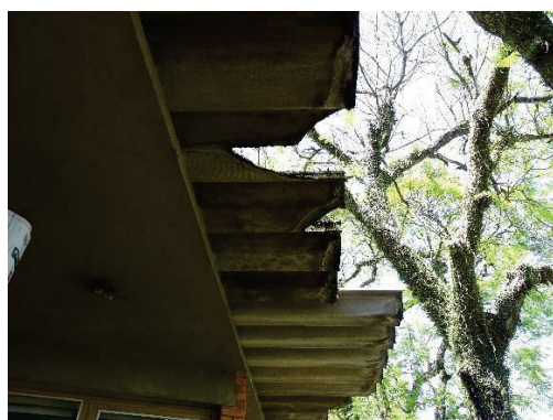
Foto 14. Dano no telhado do prédio da escolinha do DAER causado pela queda de galhos do indivíduo 5.
