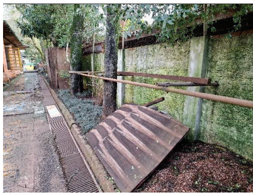
Foto 6. Indivíduos arbóreos 2 e 3 ancorando o muro para evitar a queda dele.
