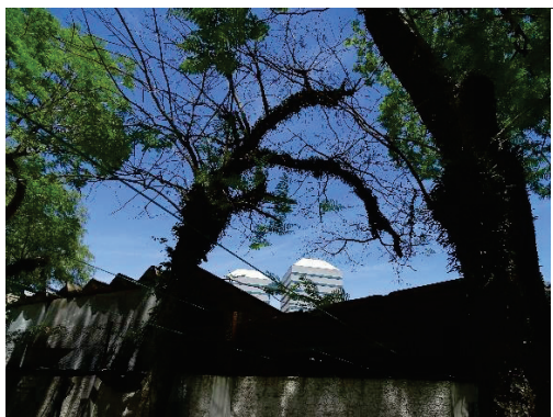
Foto 21. Vista do indivíduo 9 com projeção de copa em direção ao telhado do refeitório do CAFF.
