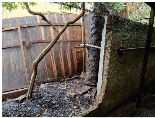
Foto 4. Queda de parte do muro devido à projeção do indivíduo 1.
