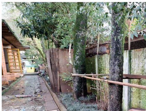
Foto 8. Ancoramento do muro nos indivíduos 2 e 3 para evitar a queda dele.
