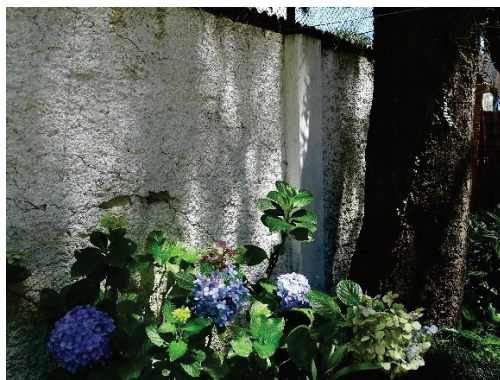
Foto 22. Dano estrutural no muro entre os indivíduos 8 e 9.
