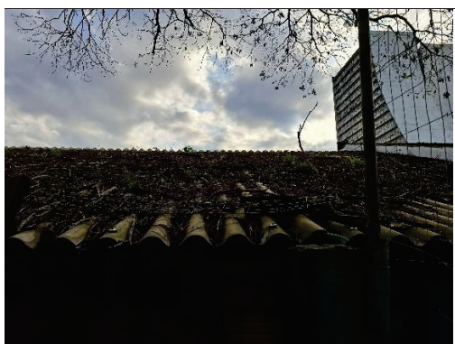
Foto 9. Acúmulo de folhas e galhos secos caídos no telhado do edifício proveniente dos indivíduos 2 e 3
