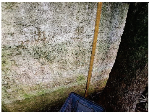
Foto 27. Rachadura no muro ao lado do indivíduo 12.
