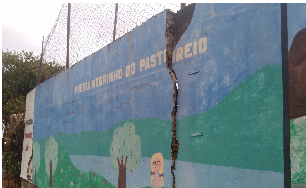
Figura 3 – Vista da rachadura no muro da divisa leste.
