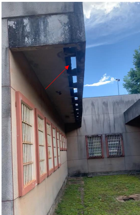
Figura 5: Vãos entre o telhado e a estrutura existente onde deverá ser instalado telamento.
