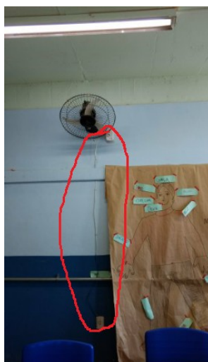
Figura 3: Fiação exposta a ser corrigida com tomada alta
