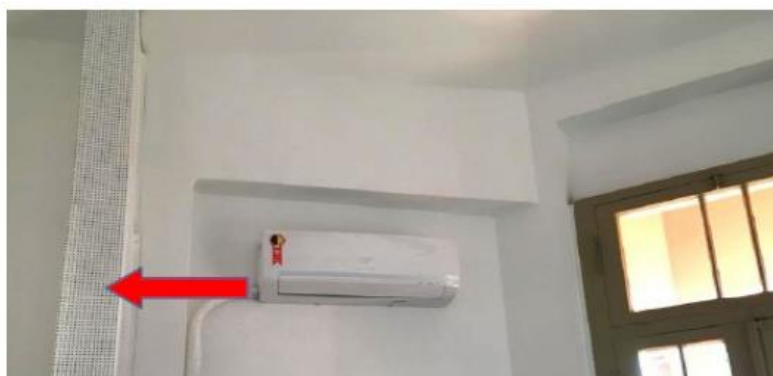
Figura 1 – localização unidade evaporadora, ao lado da tubulação interna de drenagem
