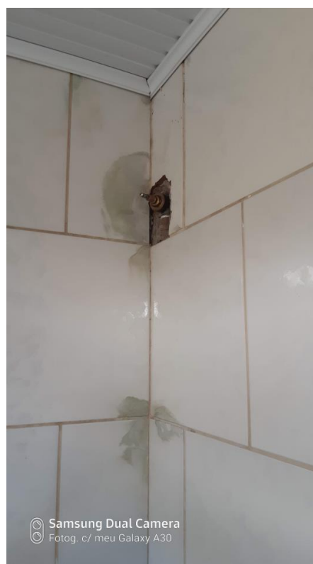
Figura 04: Registro de gaveta sem comando, cujo ramal que ele atende não faz parte do sanitário masculino de alunos.
