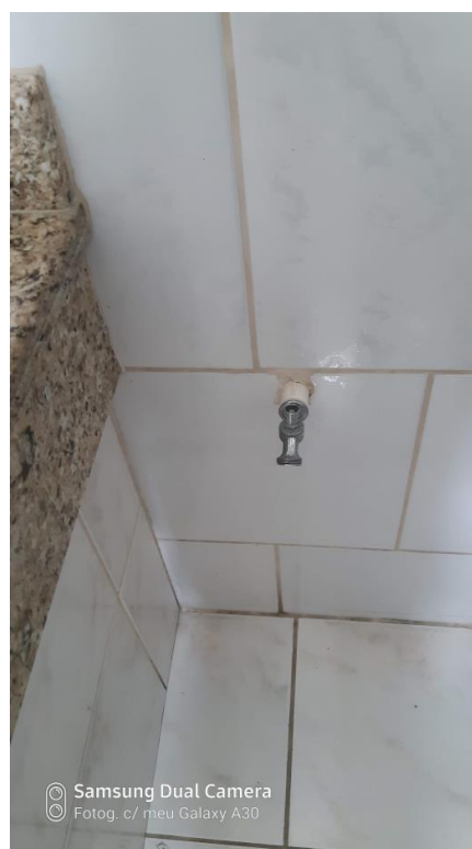
Figura 05: torneira de manutenção sem comando;
