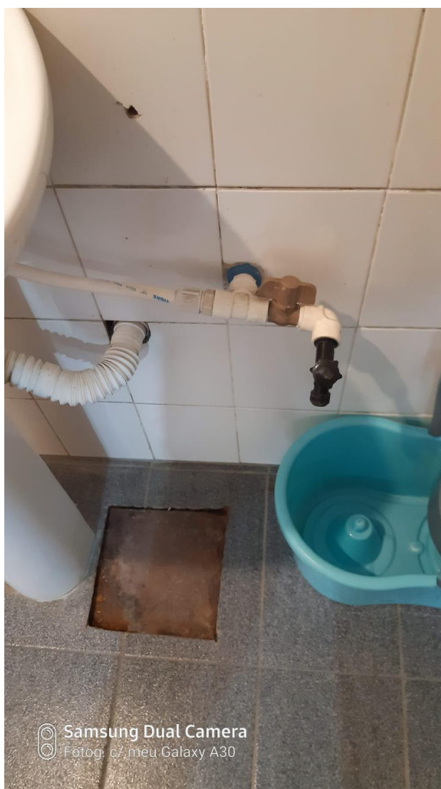
Figura 06: Ausência de grelha no sanitário. Escola adaptou um chapa metálica sobre porta grelha, pois a grelha antiga de PVC quebrou.
