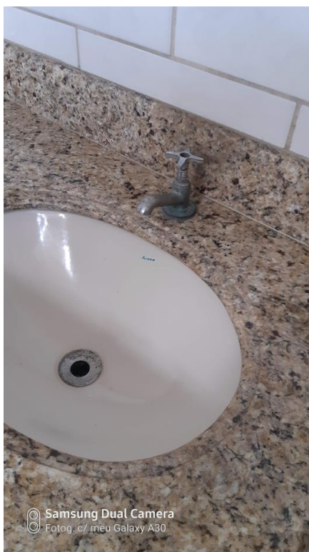
Figura 04: Torneira de bancada com vazamento;
