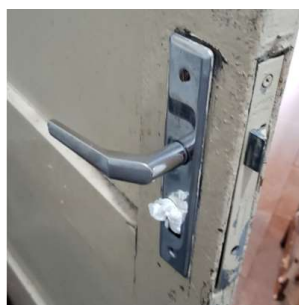
Figura 6 -Porta do banheiro dos funcionários deteriorada
