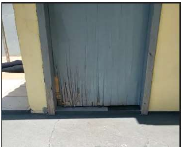
Figura 5- Porta do almoxarifado deteriorada
