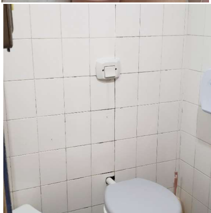
Figura 1- Vaso sanitário-Banheiro Feminino
