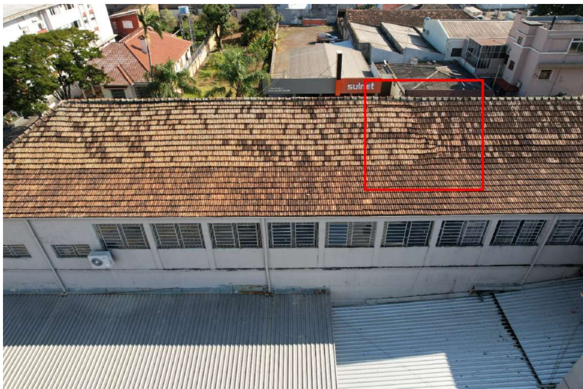
Figura 7 - Estrutura de madeira na cobertura que necessita ser revisada no Bloco 2.
