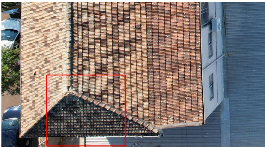
Figura 8 - Telhas e cumeeiras que necessitam ser recolocadas no Bloco 2.
