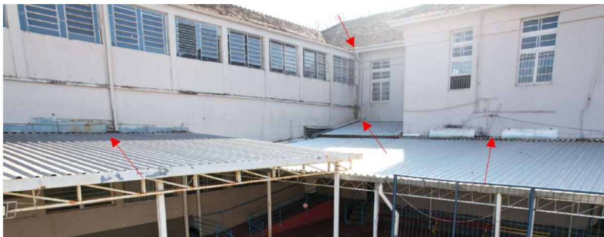
Figura 10 - Calhas e tubos de queda que necessitam ser substituídos onde interliga o Bloco 1 e 2.
