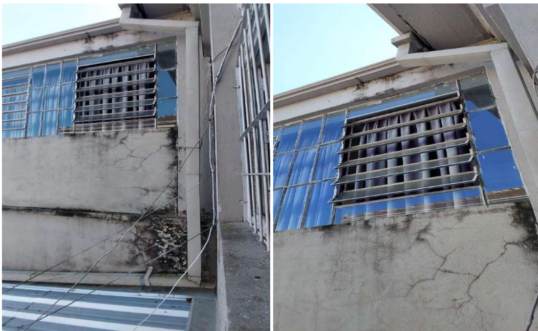
Figura 9 - Calhas e tubos de queda que necessitam ser substituídos onde interliga o Bloco 1 e 2.
