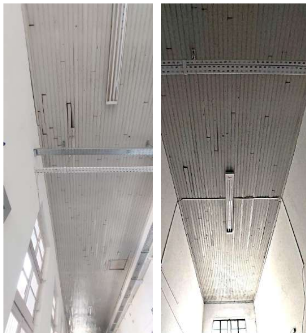
Figura 5 - Imagens do forro de madeira do corredor no Bloco 01.
