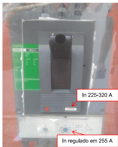
Figura 5 - Disjuntor geral junto ao QGBT Fonte: Elaboração própria
