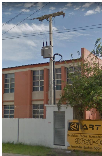
Figura 2 - Entrada de energia em MT Fonte: Elaboração própria
