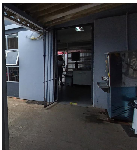
Figura 10 – Portão de ferro PE2 existente a ser alterado para portão de correr (foto de 03/2023).
